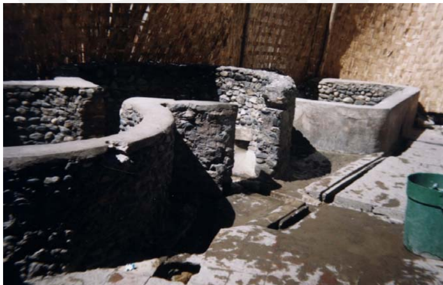
Fotografía 6. Vista de los tres puntos de emergencia del agua termomineral
