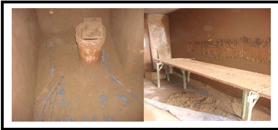
FOTO 2. Residuos de mortero en partida de tarrajeo de muros
