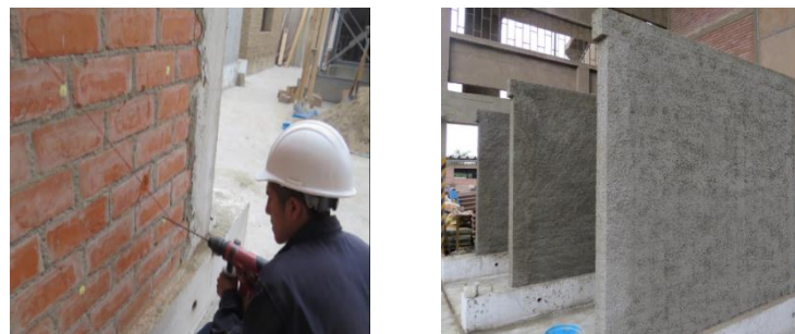
Figura 7.8 - Trabajos de perforación de muros mediante el uso del taladro (izq) y muros después del pañeteo (der)
