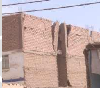
Figura 2.2 - Diafragma flexible en el último nivel, muros sin soleras
