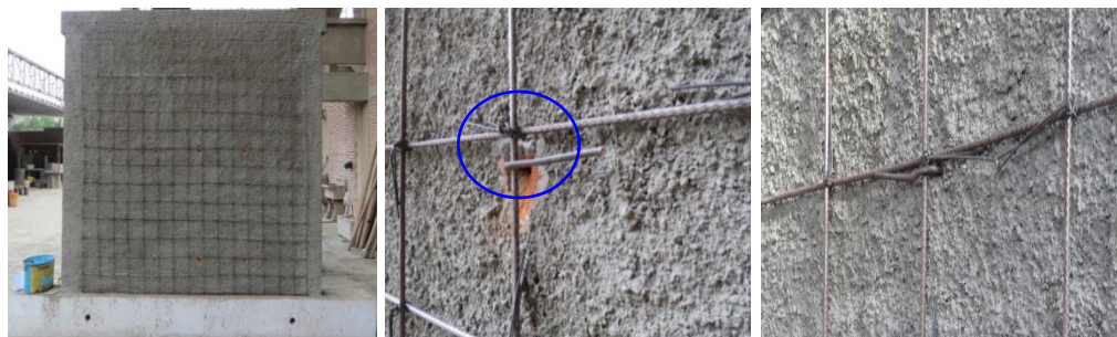
Figura 7.11 - Malla de refuerzo colocada en el muro, alambre #8 doblado a 90° y atortolado de la malla con el alambre #16
