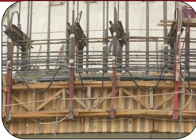
Fig. 2.13 Gatos conectados con mangueras de presión y con su control de nivel horizontal.
