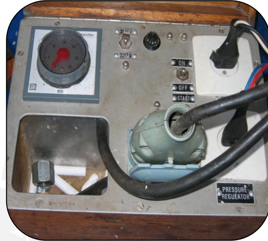
Fig.2.19 Sistema automático para control de las bombas
