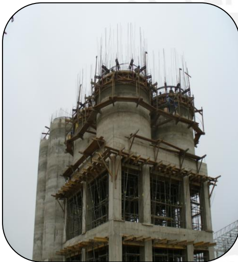
Fig. 4.1 Bateria de silos-Lurín.
