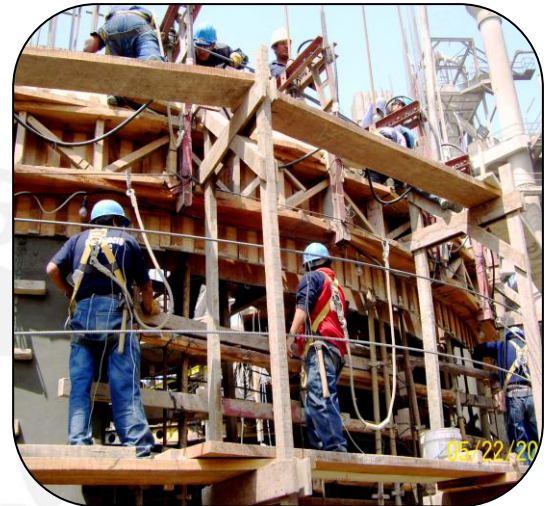
Fig. 2.9 Andamios colgantes exteriores
