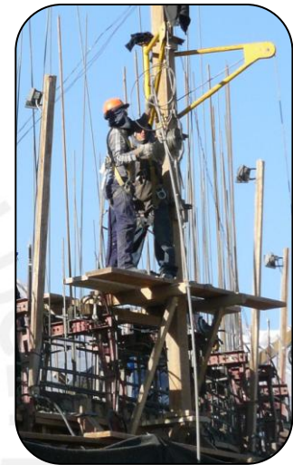
Fig. 2.12 Soporte de Inst. Eléctricas.
