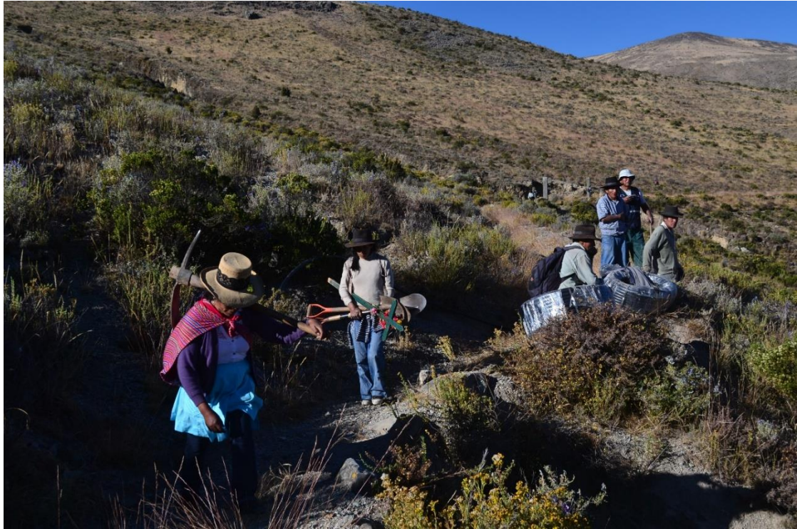
Foto 11. Presidentas de parcialidades y otras autoridades en la faena de instalación de tubos para el riego de pinos en la zona de Shogue, el 4 de agosto de 2015. Foto de la autora.
