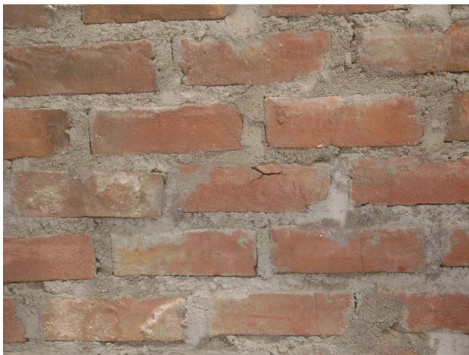
Fotografía N° 1.5: Obsérvese ladrillo agrietado en muro por defecto de contracción de secado, además de un deficiente control del espesor de las juntas.
