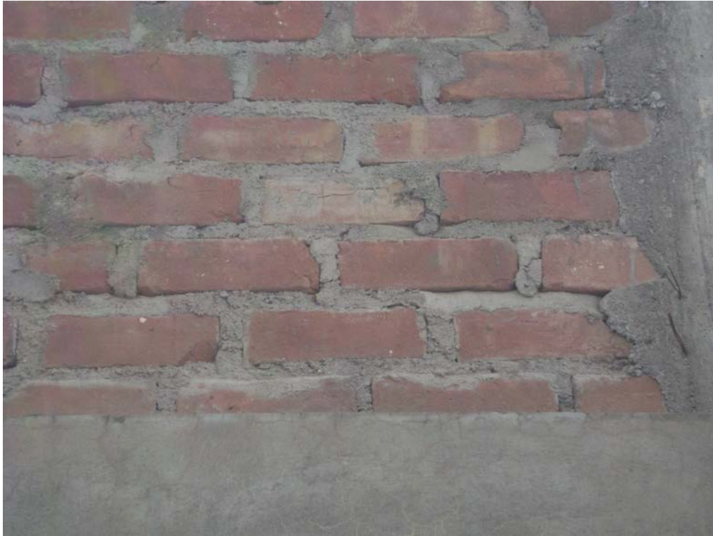
Fotografía N° 1.7: Unión dentada en muro confinado, con unidades agrietadas por contracción de secado.
