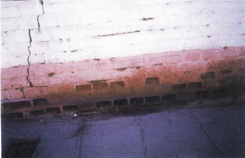
Fotografía N° 1.1: Muro de ladrillo artesanal en descomposición por falta de cocción
