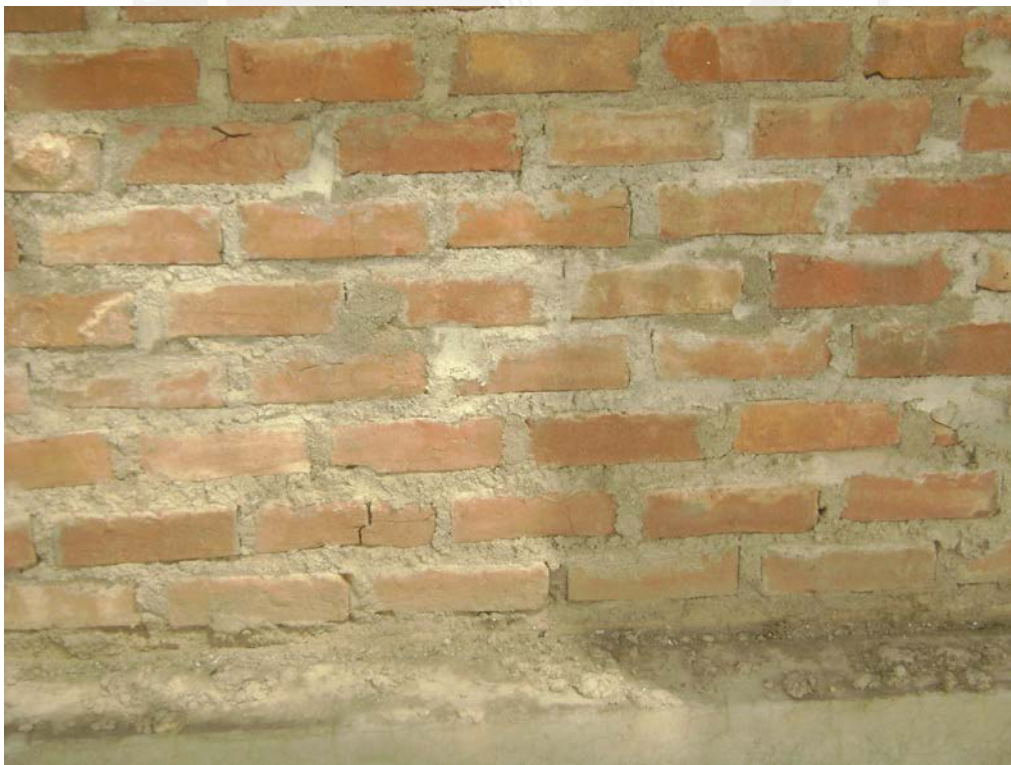
Fotografía N° 1.8: Varias unidades agrietadas por contracción de secado en un muro confinado y portante
