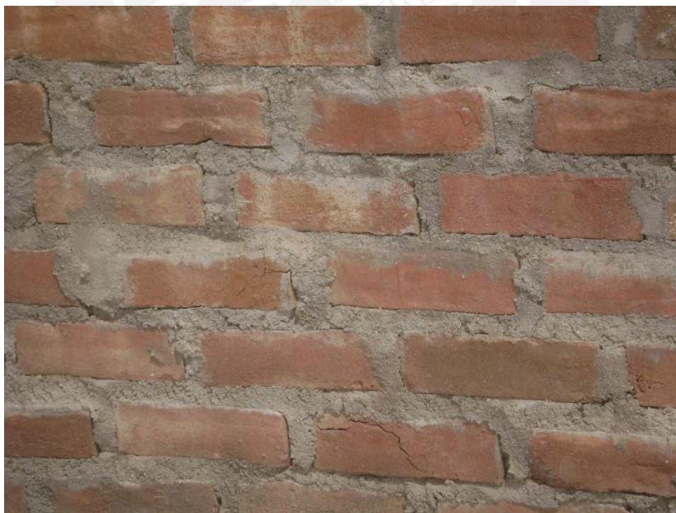
Fotografía N° 1.6: Las grietas por contracción de secado no tienen una característica definida, siguen por donde el agua de amasado se elimina con más rapidez, lo que indica que en la fase de "madurado" no se logra una masa uniforme, algunas partes quedaran con mayor contenido de agua.
