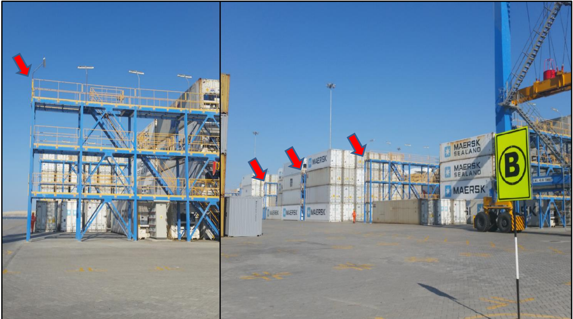
Figura 30. Imágenes de las tomas reefer del Puerto de Paita.
