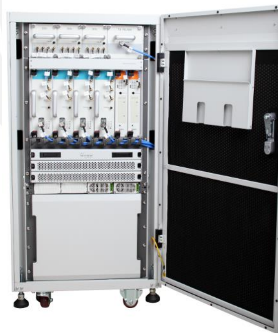
Figura 26: DIB R5 Equipado con cuatro (04) portadoras y controlador redundante (BSC) - Fuente: Hytera Mobilfunk GmbH
