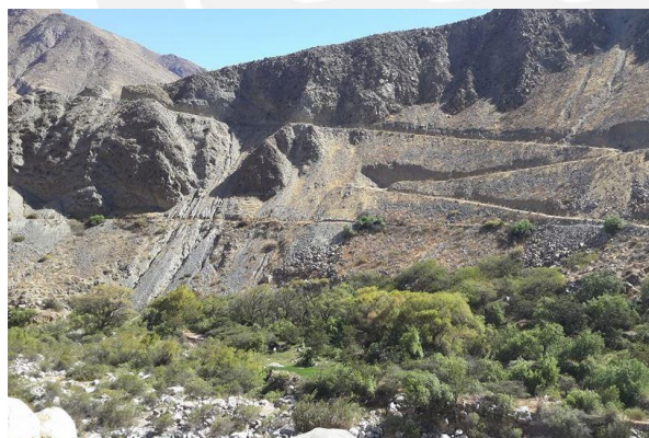
Figura 2.3: Derrumbe en el camino al centro poblado de Willcayoc (Fuente: Elaboración propia)
