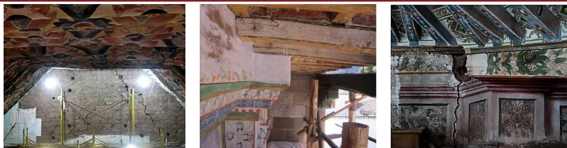
Figura 2.2 Algunas de las patologías más resaltantes en la iglesia
