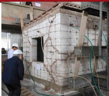
a) Inspección de daños
