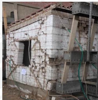
b) Daños en la casa
