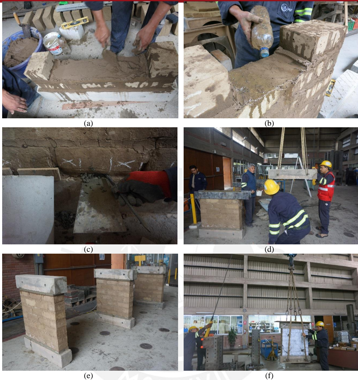
Figura 4.3. Proceso constructivo de muretes (a) asentado de adobes (b) humedecimiento de adobes (c) reemplazo de junta de mortero de barro por mortero de cemento (d) colocación de dintel en muretes (e) especímenes finales y (f) colocación de especímenes en posición de ensayo.
