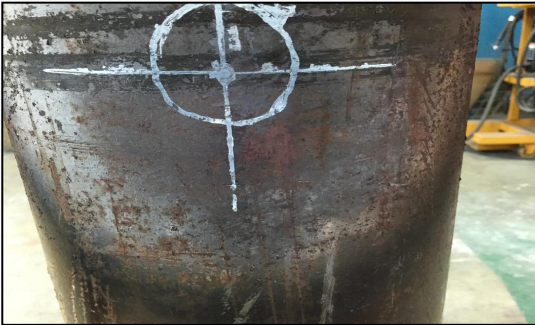
Figura 3.1 Zona del primer daño.
