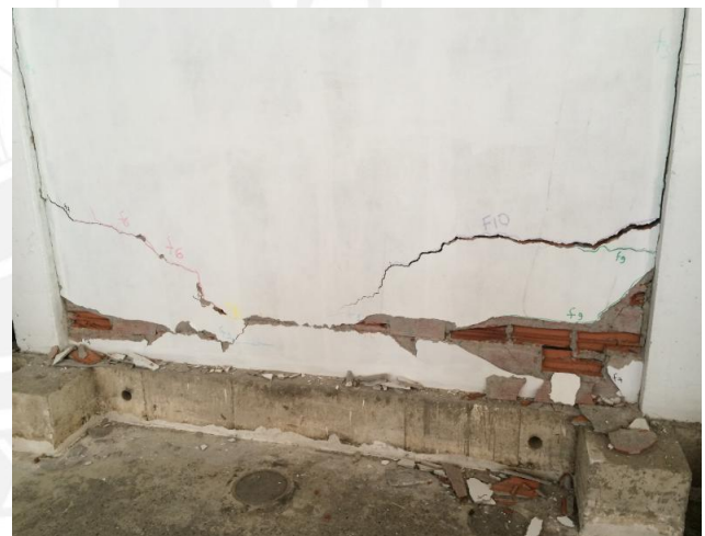
Foto 54. Tabique con fisuras diagonales en parte inferior, y falla por cizalle.
