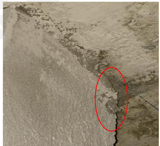
Foto 60. Fase 5, desprendimiento de pasta cementante.
