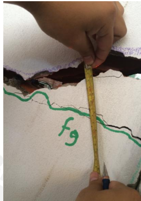
Foto 53. Espesor de grieta de 2.5 cm.
