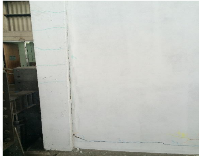
Foto 47. Desprendimiento en la parte lateral del tabique.
