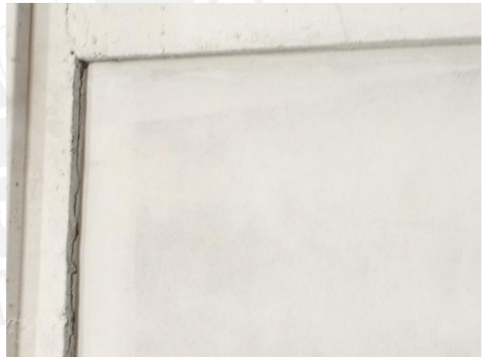
Foto 46. Desprendimiento de pasta cementante entre columna y tabique.
