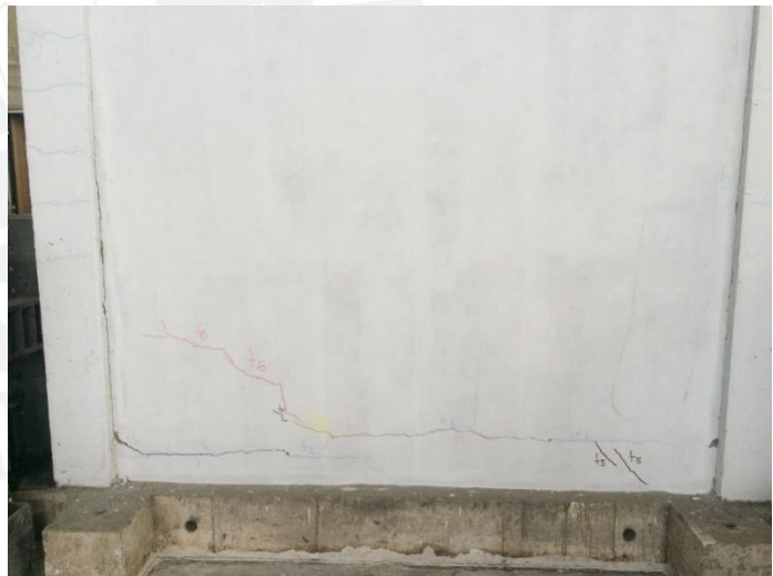
Foto 48. La fisura F6 aparece diagonalmente en la parte inferior izquierda.
