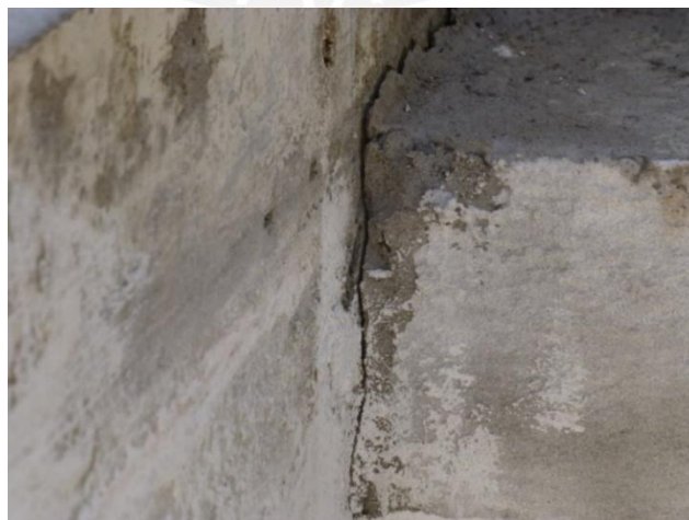
Foto 67. Falla en junta entre columneta y viga.
