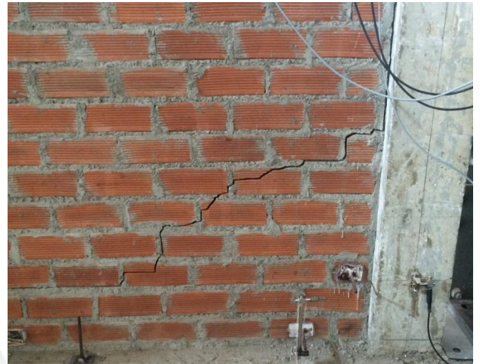
Foto 51. Falla diagonal en la parte inferior del tabique
