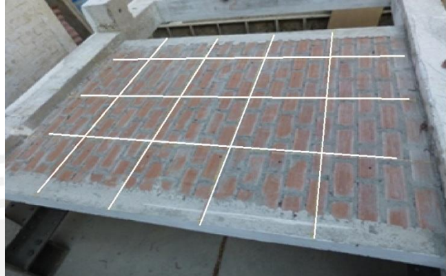
Foto 63. Tabique con recuadros marcados.
