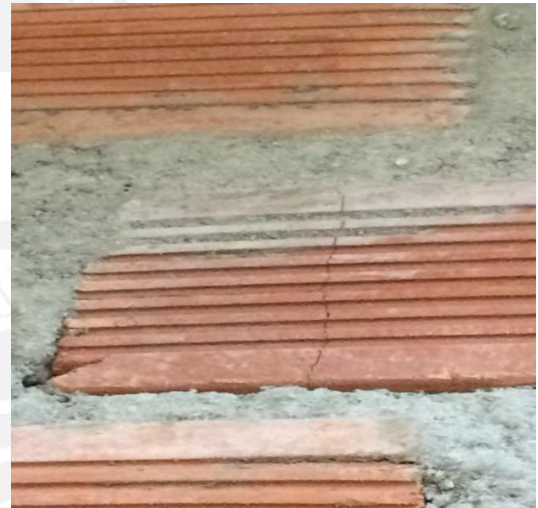
Foto 62. Fisuras en ladrillos.
