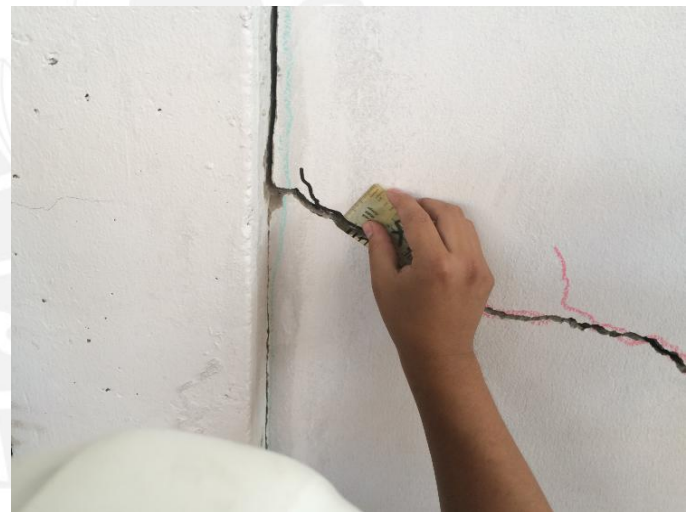
Foto 52. Fisura con un desprendimiento parcial de la pasta cementante.
