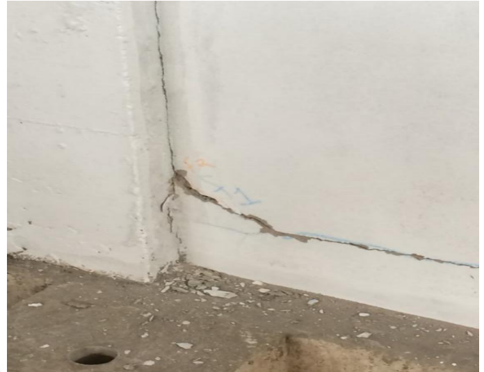
Foto 49. La falla presenta un incremento en cuanto a espesor de la fisura F1 de 3mm a 5mm.
