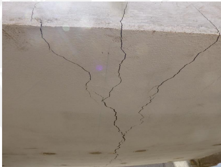
Foto 69. Presencia de fisuras en la cara tarrajada, el peso de las bolsas de arena empiezan a ocasionar problemas de falla por flexión.
