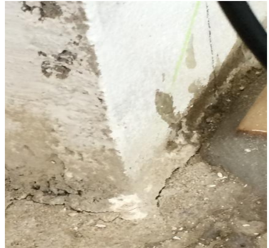
Foto 61. Desprendimiento de pasta cementante
