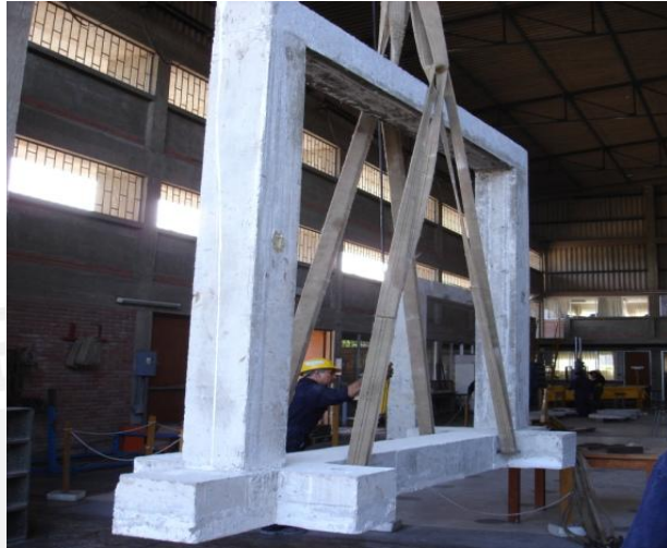
Foto 2. Sistema de Izaje del Pórtico
