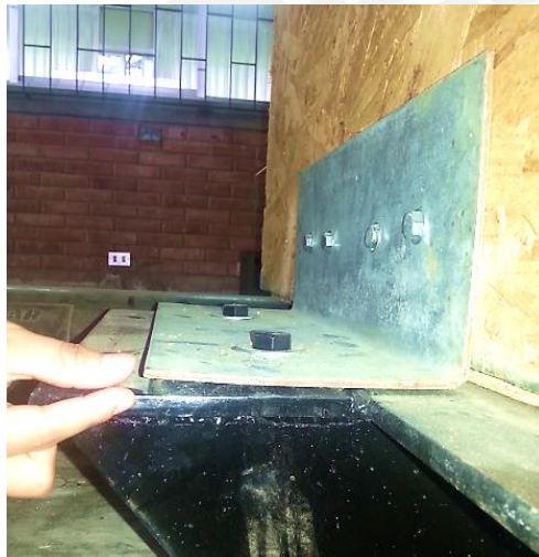
Ilustración 7.3 Fase 3. Descuadramiento de las uniones de la conexión cimentación- módulo.
