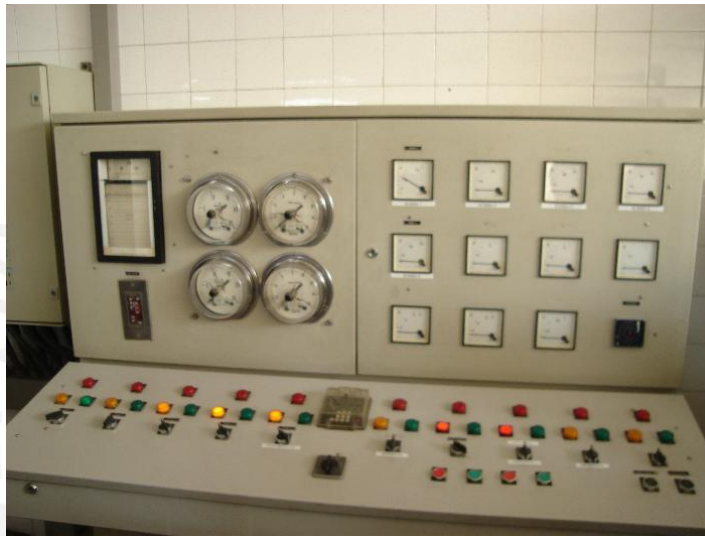
Figura 1.7. Antigua sala de control
