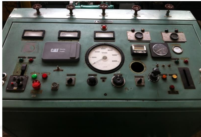
Figura 3.6 – Panel de control de los motores de banco
