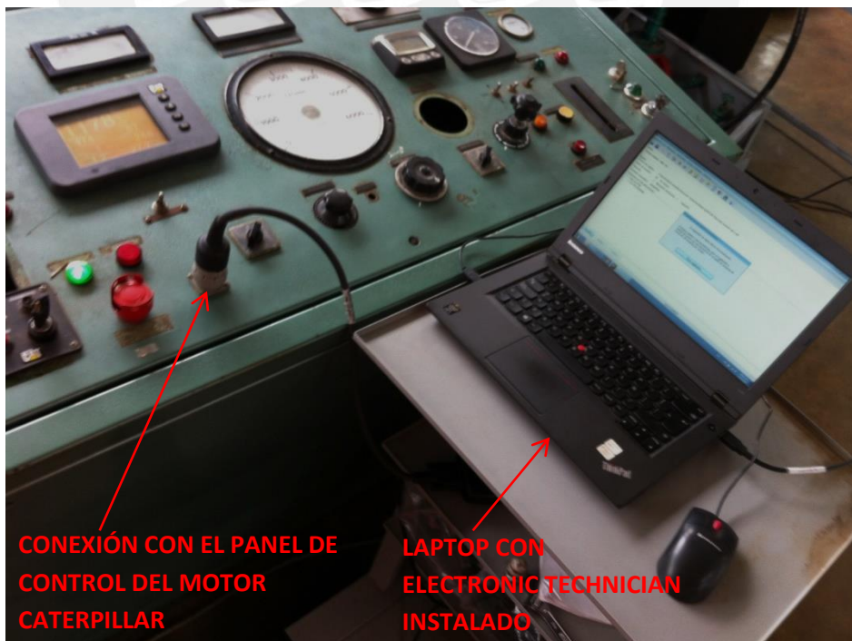
Figura 3.25 – Conexión al ECM Caterpillar
