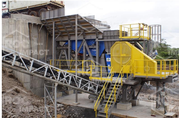
Figura 2.1. Imagen de una estructura metálica en un proceso de chancado. Fuente: Concasseur. [1]
