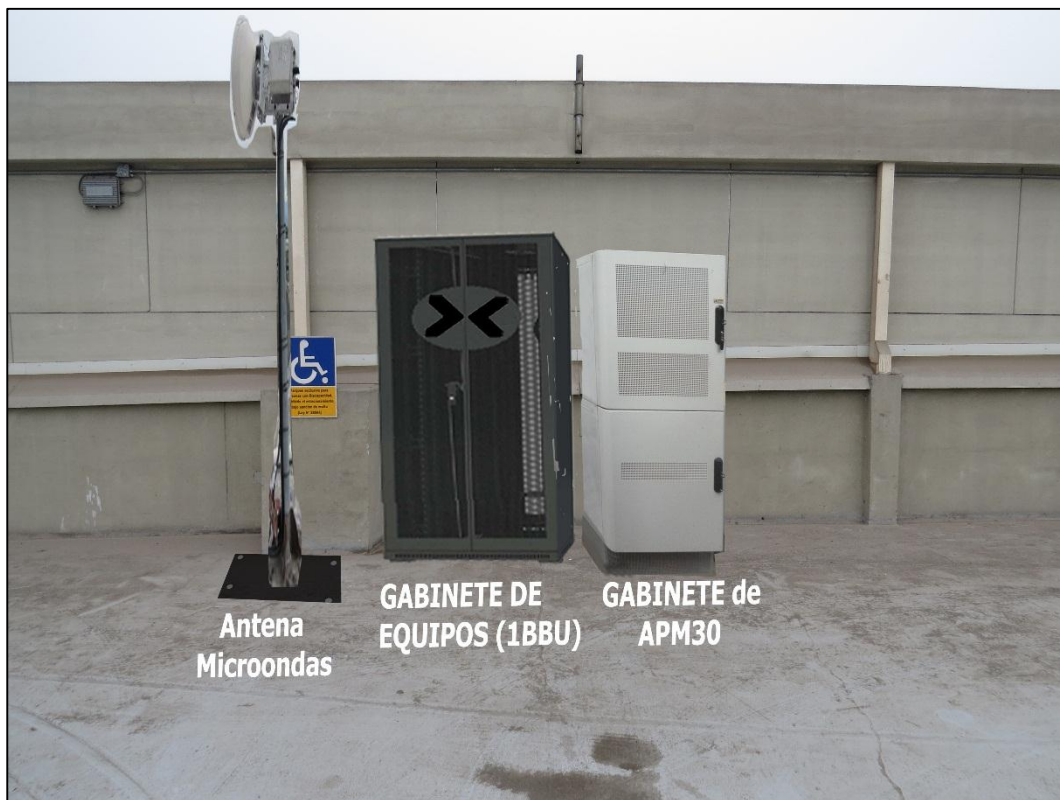
FIGURA 1-1: BBU-APM30 Y ANTENA MICROONDAS
