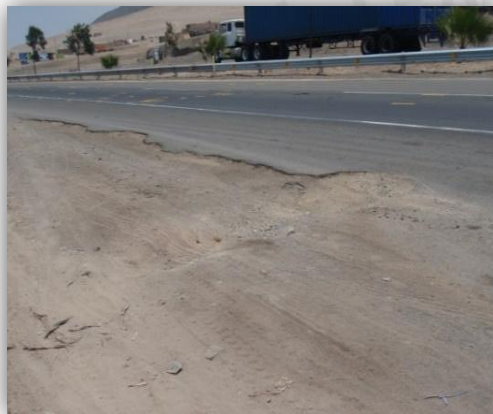
Foto 39: Mal estado de la calzada.
