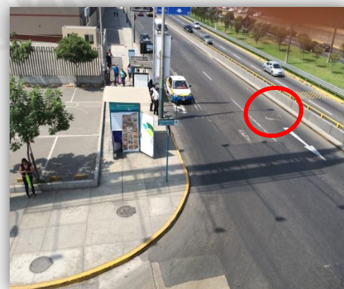
Foto 82: Agrietamiento profundo (piel de cocodrilo) en el pavimento.
