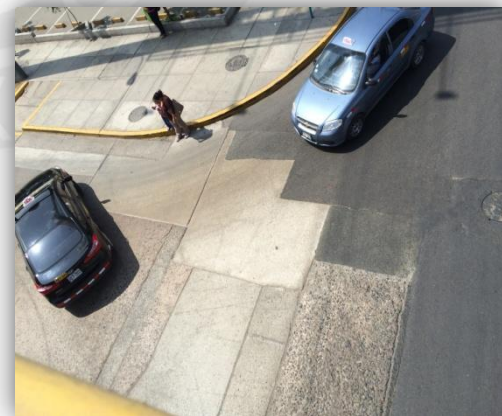
Foto 94: Pavimento con descacaramiento.
