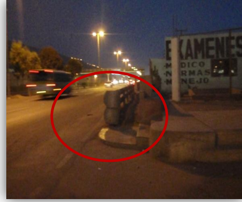
Foto 138: Elemento de concreto sin protección contra colisiones.
