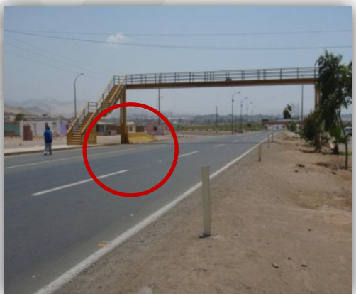
Foto 48: Estructura de concreto de alto peligro para conductores.
