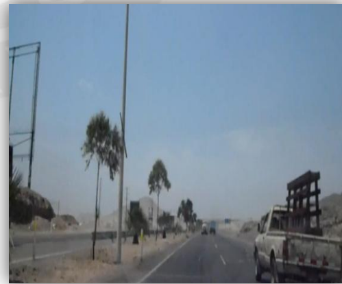
Foto 72: Poste de alumbrado en la mediana, sin protección.
