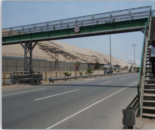
Foto 125: Puente Peatonal con guardavías en sus bases para protegerlas contra colisiones.
