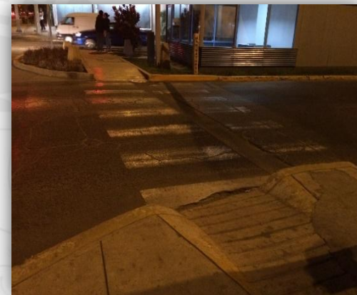
Foto 22: Rampas en mal estado (zona La Molina).
