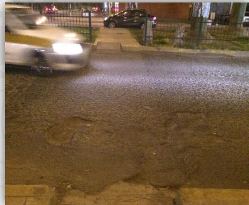
Foto 34: No hay continuidad de rampas (o mal diseñadas).
