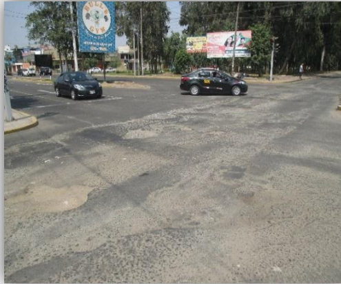
Foto 7: Pavimento asfáltico en mal estado (zona Ate).
