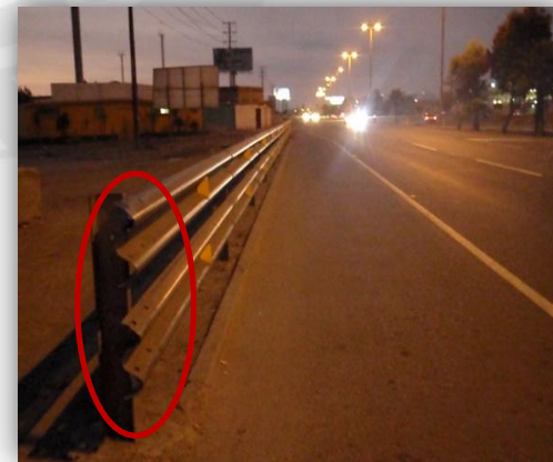
Foto 136: Guardavía entre los accesos 4 y 5 sin terminación en un extremo (Inadecuado para Carril Reversible).
