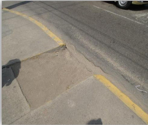
Foto 13: Rampa de discapacitados en mal estado (zona La Molina).
