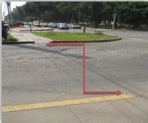
Foto 9: Calzada en mal estado, discapacitados tienen problemas al cruzar debido a baches.
