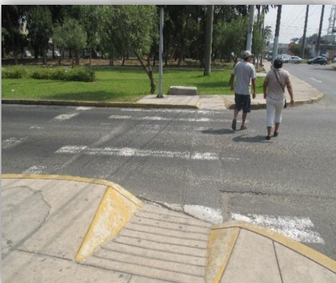
Foto 17: Líneas peatonales desgastadas y no hay continuidad de rampas.
