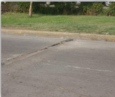
Foto 87: Grietas profundas cercanas a las juntas del pavimento de concreto.
