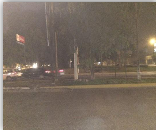
Foto 38: Elementos duros y peligrosos en la mediana.
