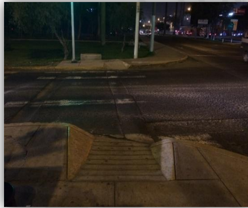
Foto 21: Discontinuidad de rampas y señalización en calzada desgastada.
