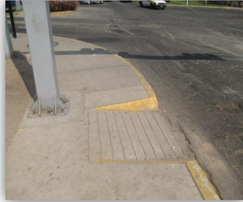
Foto 14: Rampa peatonal obstaculizada por semáforo (zona La Molina).
