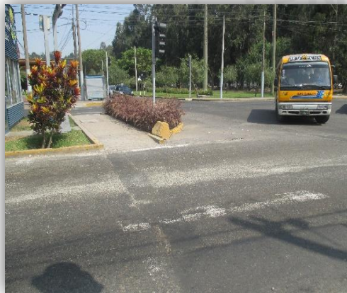
Foto 15: No existe línea de PARE y líneas de cruce peatonal se encuentran desgastadas.
