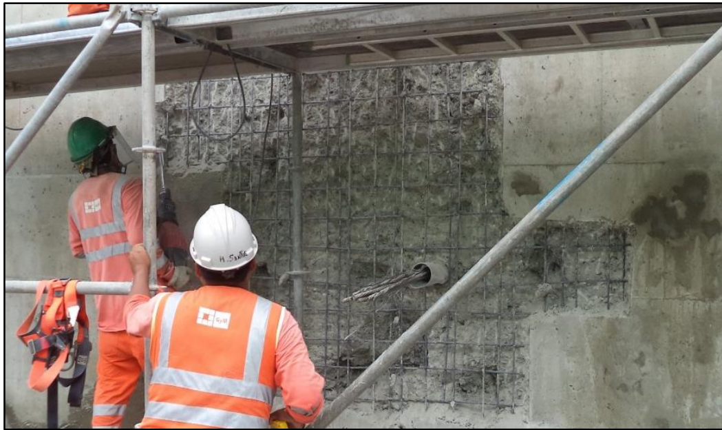
Fig. 4.3. Demolición de muro por ocurrencia de cangrejera. (Fuente: Propia)
