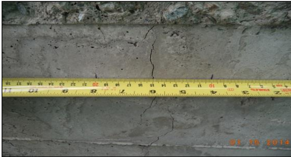
Fig. 4.10. Ocurrencia de fisuras en los muros del proyecto. (Fuente: Propia)
