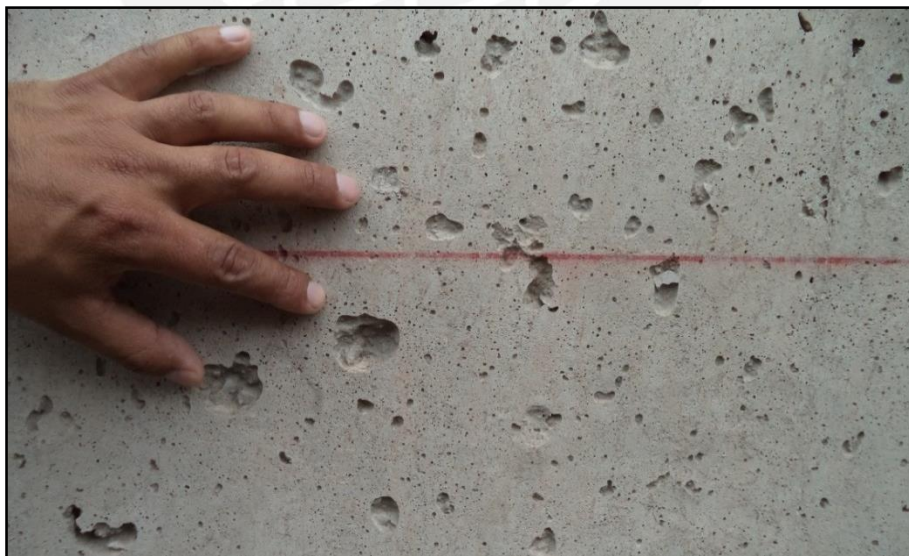
Fig. 4.5. Muro afectado con burbujas. (Fuente: Propia)
