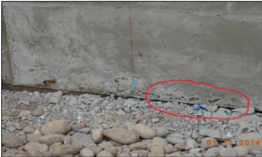
Fig. 4.12. Segregaciones en un muro del proyecto. (Fuente: Propia)
