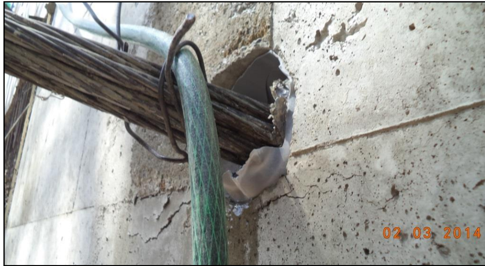
Fig. 3.13. Resane necesario en la zona de los anclajes.
