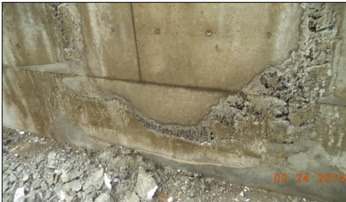
Fig. 4.11. Juntas frías en un muro del proyecto. (Fuente: Propia)
