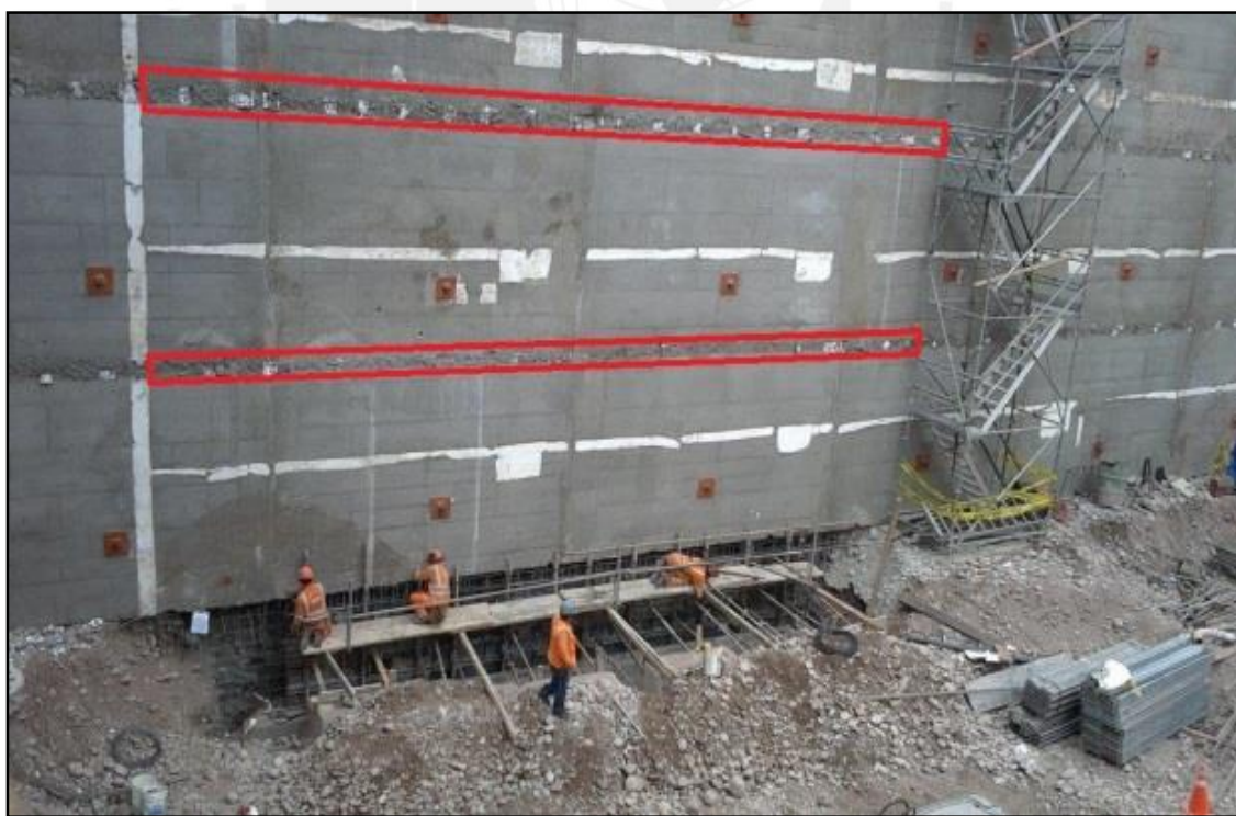
Fig. 6.1. Costura de unión de muros generada por la desincronización de niveles. (Fuente: Propia)
