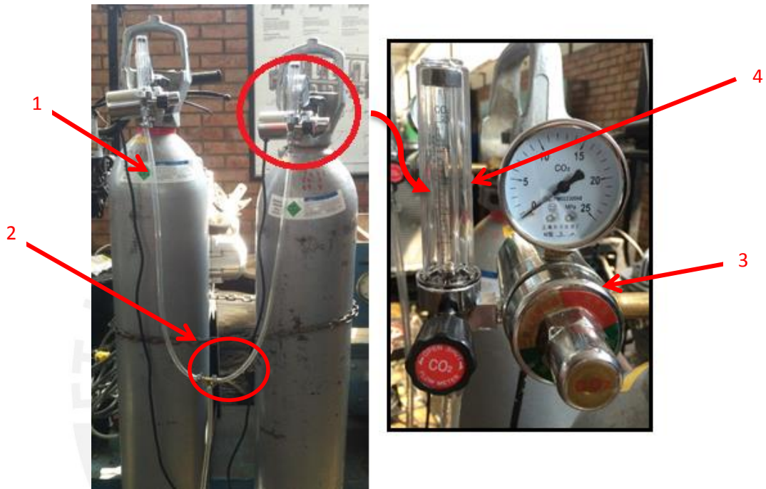
Figura 32 – Cilindros de dióxido de carbono de 30 kg con su regulador de flujo.
