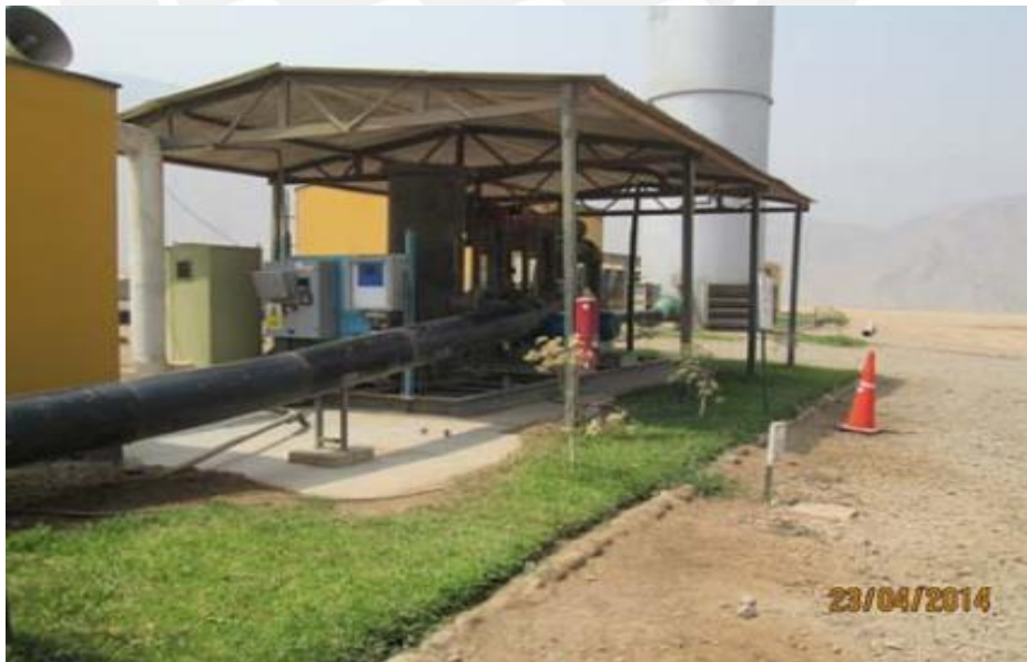
Figura 21- Planta de tratamiento del biogás en la Gringa V [19].
