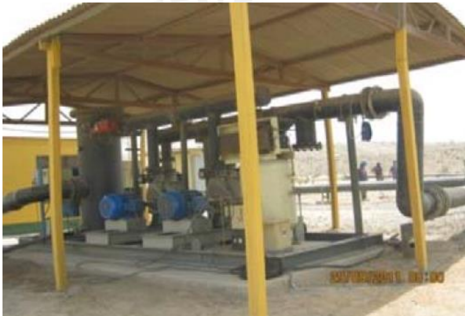
Figura 19 Planta de tratamiento de gas de Huaycoloro, Lima [18].
