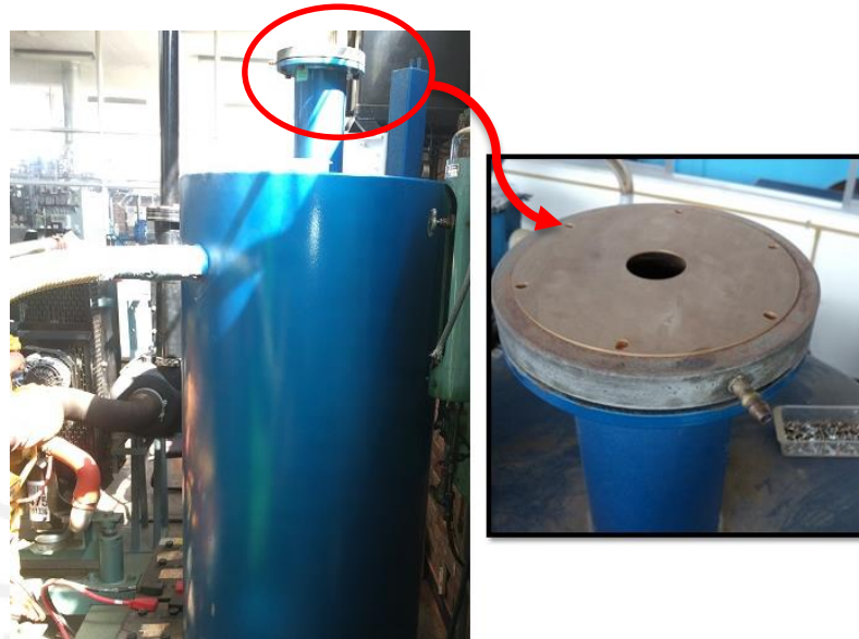
Figura 27 – Tanque pulmón con placa orificio.
