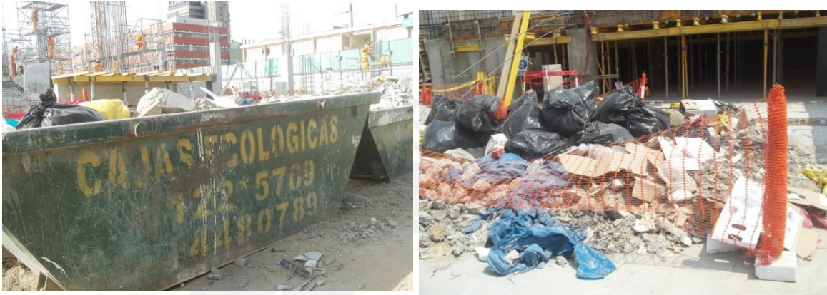
Figuras 3.18 y 3.19: 3.17 (izquierda) Caja Ecológica de la obra. 3.18 (derecha) acopio temporal de residuos de la obra. Fuente propia
