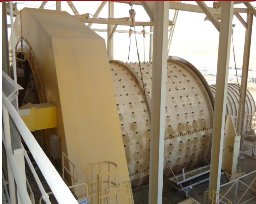
Figura 2-9. Molino SAG de Minera Yanacocha
