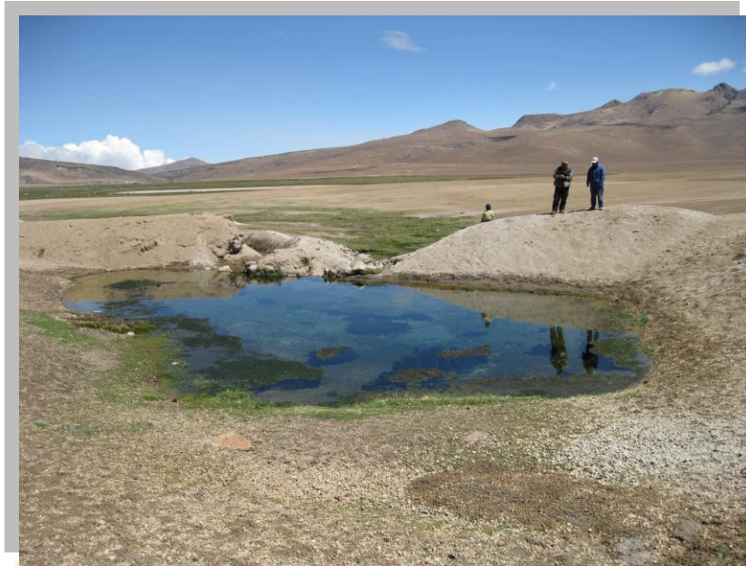
Vista que muestra una micropresa terminada, en la zona de Chojata en General Sánchez Cerro – Moquegua.
