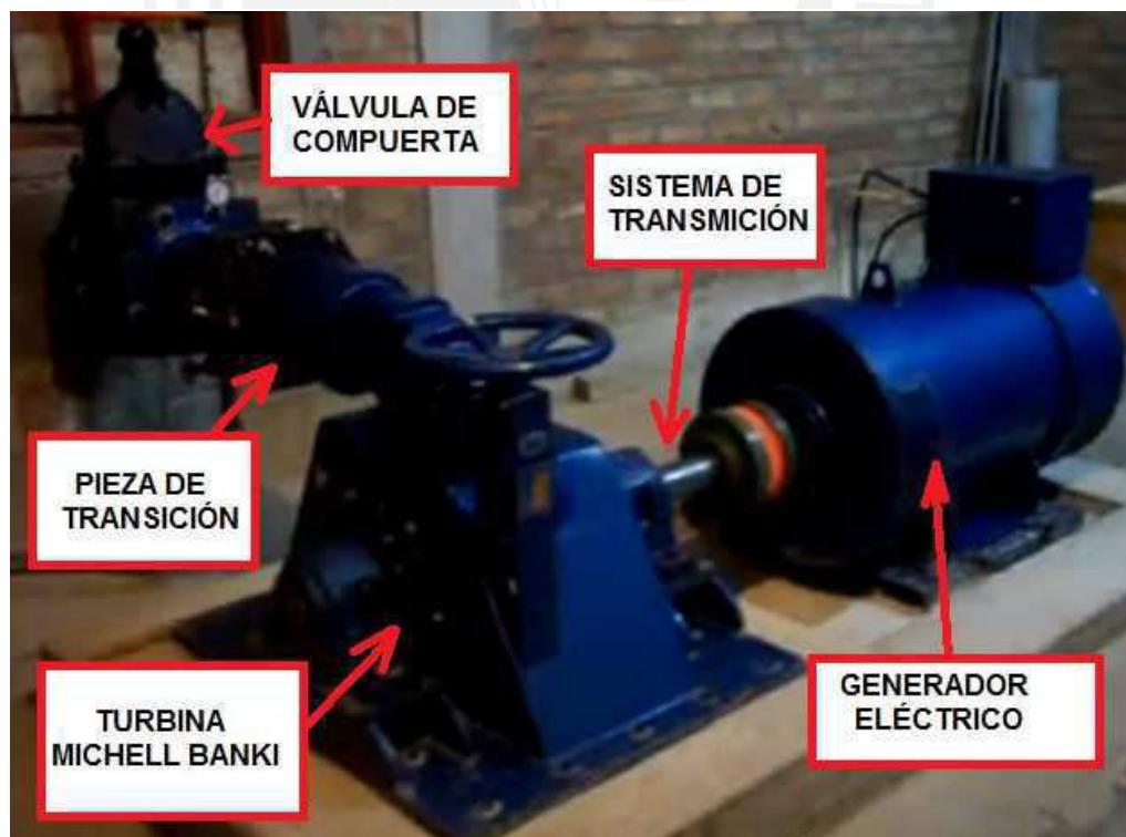
Figura 1.5: Grupo hidroenergético de 100 kW con turbina Michell Banki en Chunchuquillo – Cajamarca [Ref. 21].
