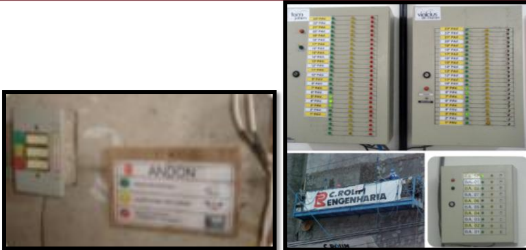
Imagen 39. Sistema de alarmas (De Vasconcelos, 2011)
