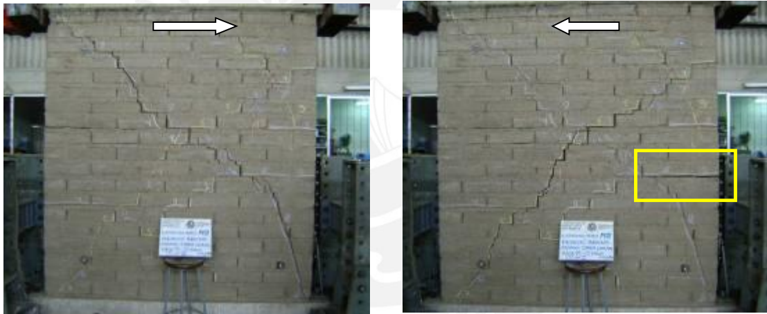
Fig.7.16. M2. Fase 10. A la derecha se observa la grieta horizontal en la zona de empalmes de los tubos PVC verticales.
