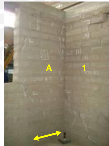
Fig.8.9. Fase 2. Fisuras en la esquina interior 1-A.
