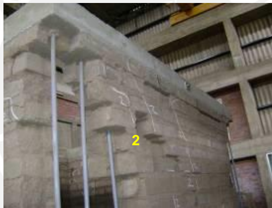
Fig.8.11 Fase 2. Grieta en la base de la última hilada. Nótese que la unión solera-adobe no tuvo problemas, excepto en las esquinas del eje 2.
