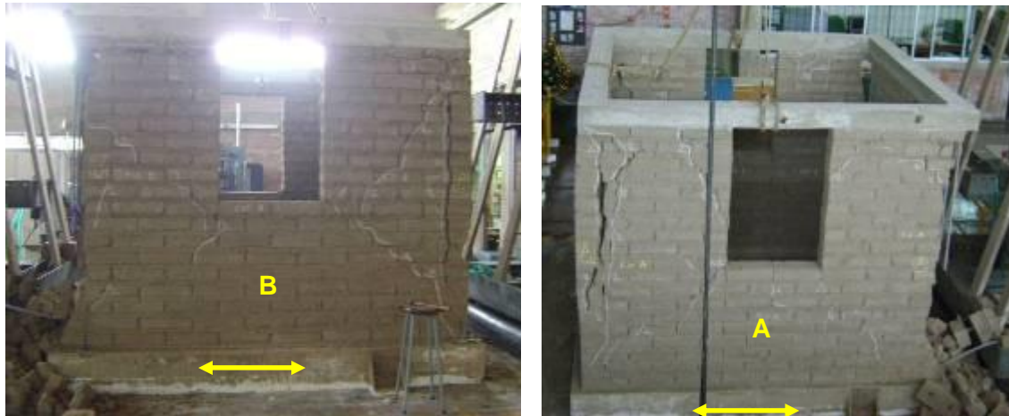
Fig.8.10. Fase 2. Fisuras diagonales en los muros de corte A y B.
