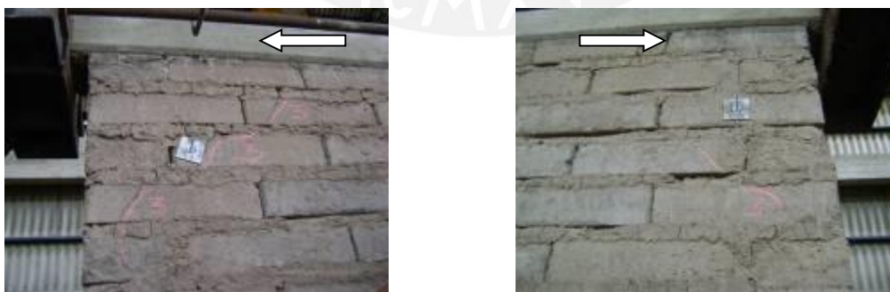
Fig.7.18. M1. Fisuras de 5 adobes en la fase 3.
