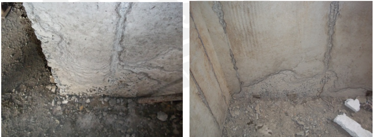
Fig. 4.1. Segregación en la base de los muros-Obra: Villa Santa Clara.
