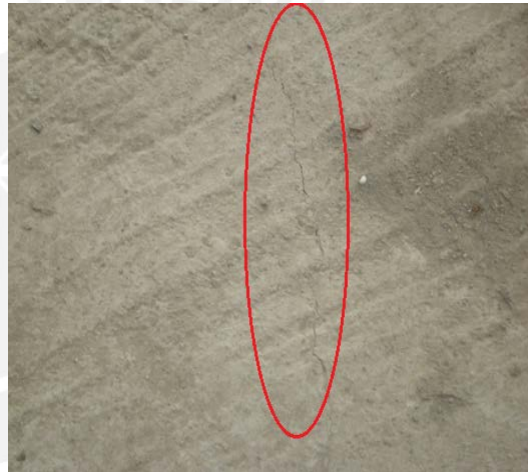
Fig. 4.4. Fisuras en la losa del segundo piso-Obra Terrazas de la costanera.
