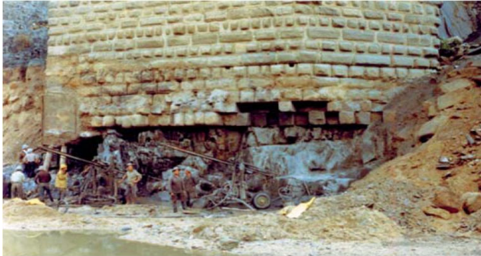
Figura N° 3.34: Socavación en un pilar del puente de Alcántara.
