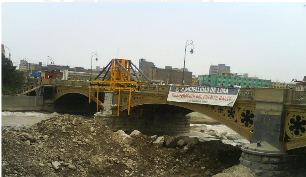
Figura N° 4.7: Trabajos de reconstrucción en el pilar dañado, así como también la recuperación del ornamento de su arco.
