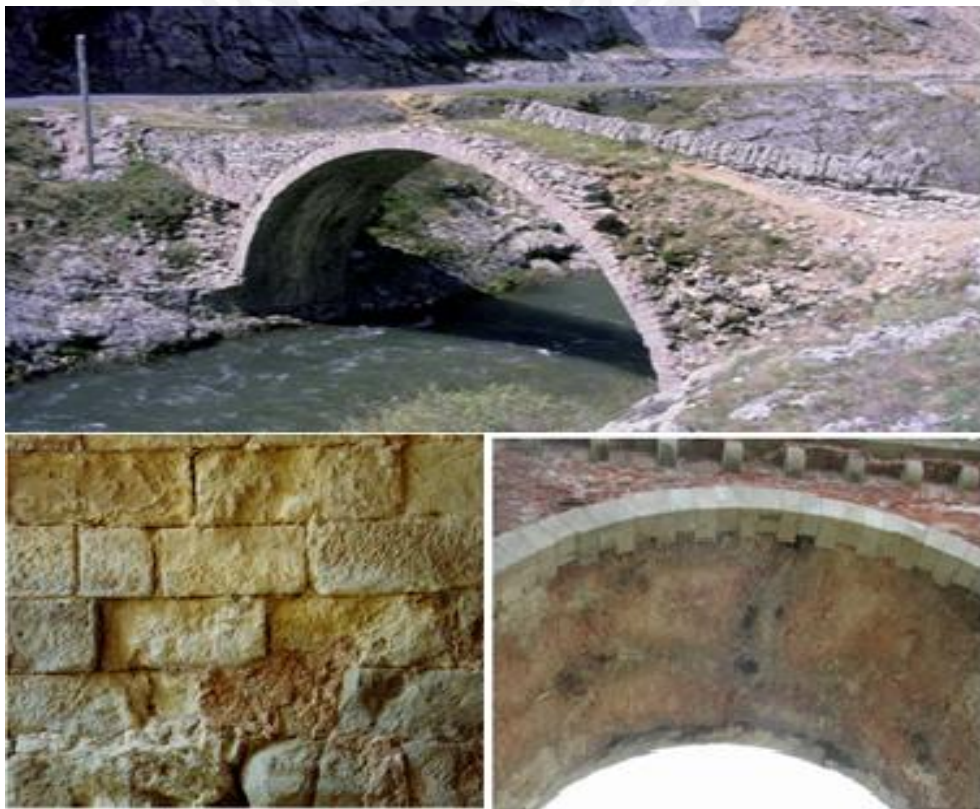
Figura N° 3.36: Degradación del material presentado en los puentes de mampostería.
