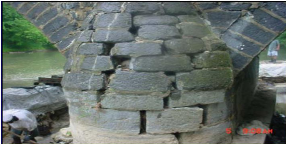
Figura N° 3.35: Movimiento en uno de los pilares de un puente.
