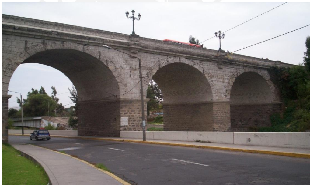
Figura N° 4.11: Podemos observar el espesor que presenta aparentemente la bóveda del arco, notamos además los candelabros que son muy similares a los que presenta el puente Trujillo de Lima.
