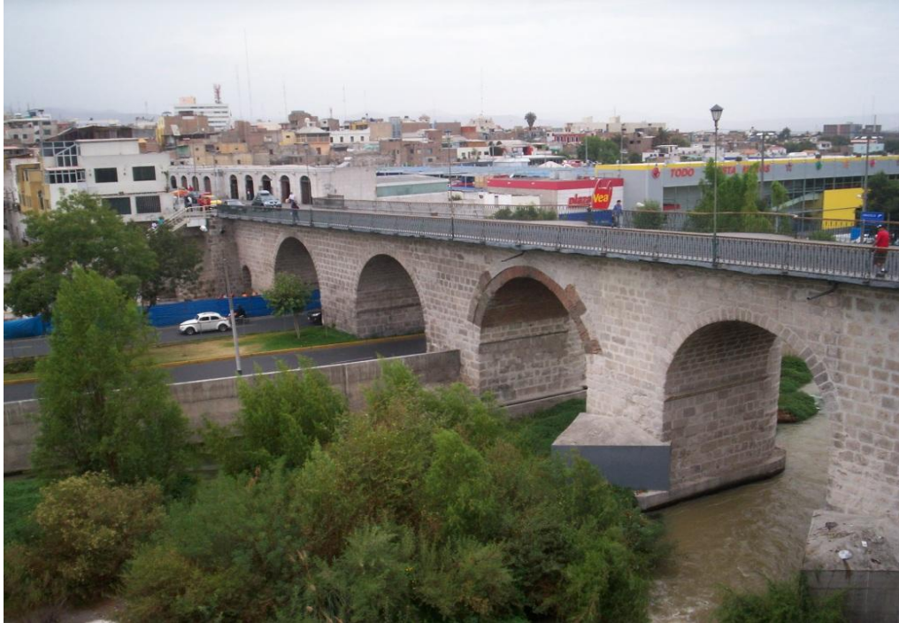
Figura N° 4.9: Vista actual del puente Bolognesi, nótese los tajamares de concreto en un trabajo de prevención contra las crecidas del río. Además la presencia de la avenida La Marina.
