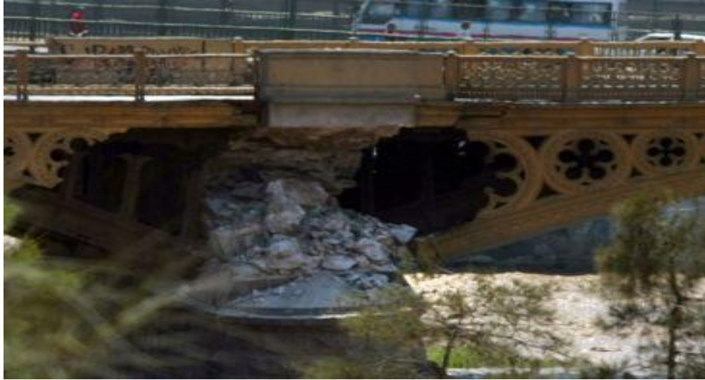
Figura N° 4.6: Puente Balta con un pilar afectado y el ornamento de su arco dañado, debido a la gran crecida que tuvo el río y al poco mantenimiento.
