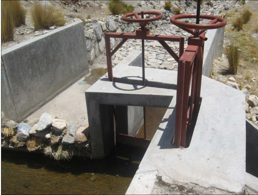
Imagen 7. Repartidores de cemento y compuertas de metal
