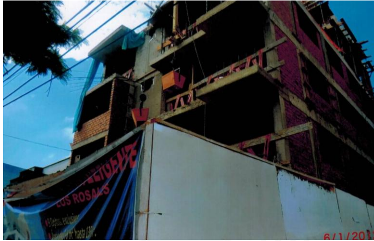
Figura 3: Obra no cuenta con mallas contra caídas de altura
