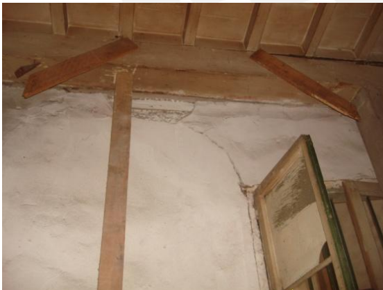
Foto 23: Grieta que llega a la esquina superior del vano.
