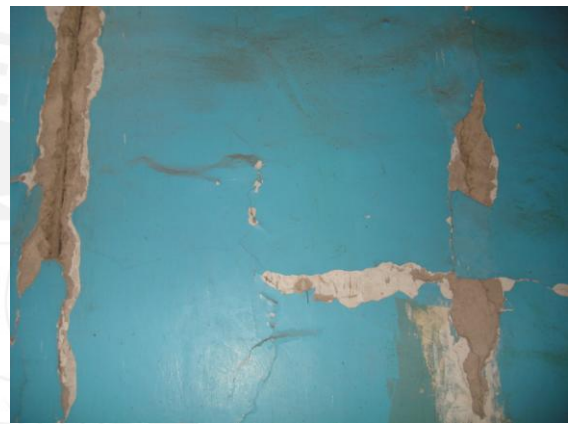
Foto 40: Grietas en muro de quincha.
