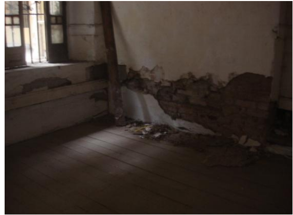
Foto 2: Desprendimiento del recubrimiento y algunas grietas profundas
