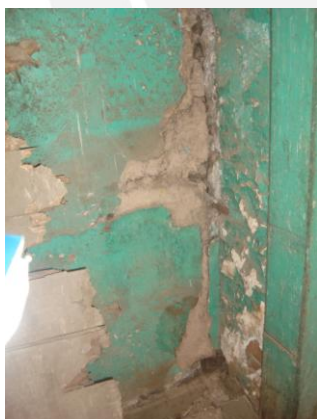
Foto 47: Grieta en la unión de muros.
