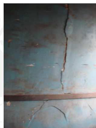
Foto 52: Grietas en muro de quincha.
