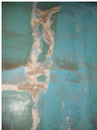
Foto 63: Grietas en muro de quincha.
