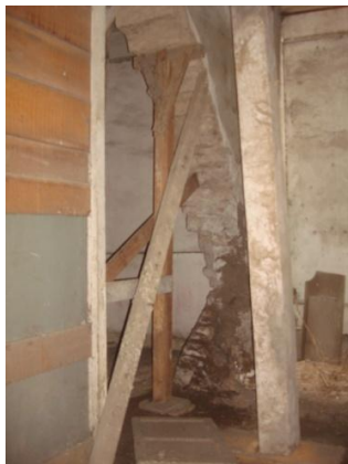
Foto 21: Colapso de muro.
