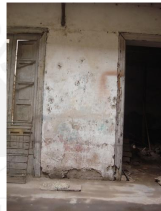
Foto 34: Desprendimiento de material en la base del muro.
