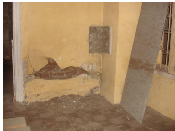
Foto 14: Desprendimiento de recubrimiento.
