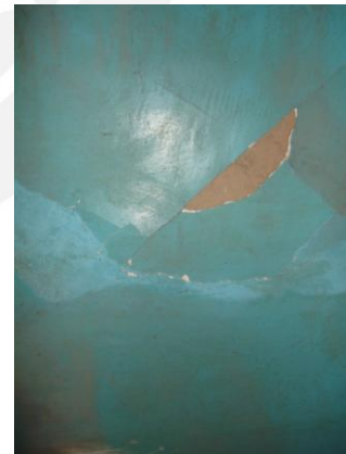
Foto 66: Desprendimiento de material y grietas.
