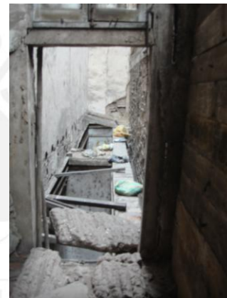
Foto 64: Colapso de muro.
