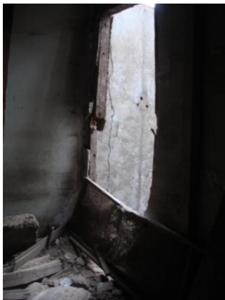
Foto 75: Colapso de muro.
