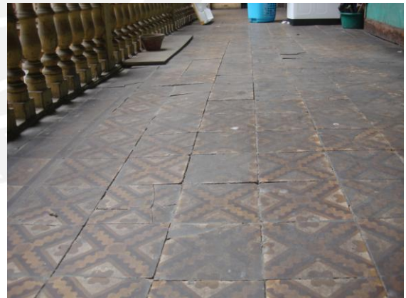
Foto 42: Deflexión de losa.
