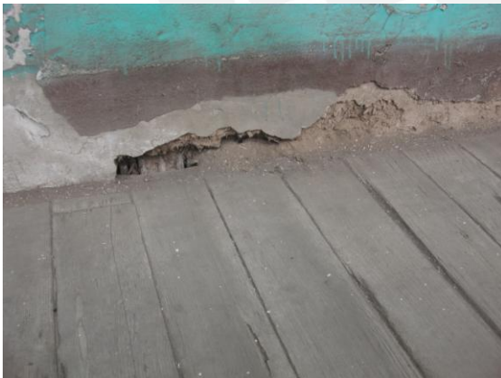
Foto 77: Pérdida de material.
