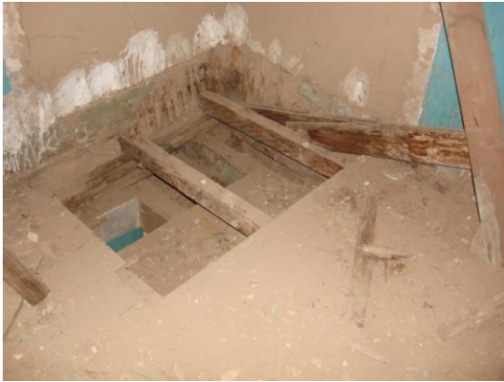
Foto 91: Sistema de entrepiso en mal estado.
