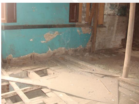
Foto 53: Sistema de entrepiso en pésimo estado.
