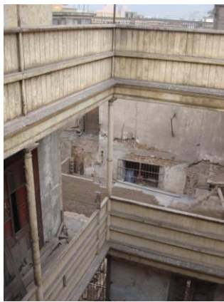
Foto 81: Colapso de estructura.
