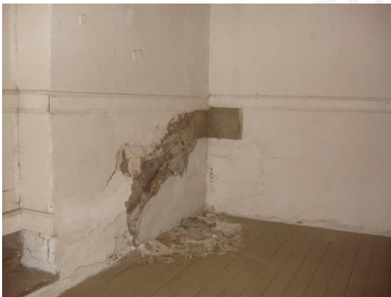
Foto 3: Grietas en muro y desprendimiento de material.
