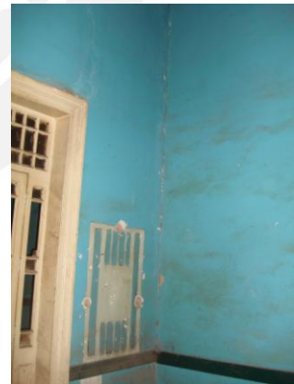
Foto 72: Grieta en unión de muros.
