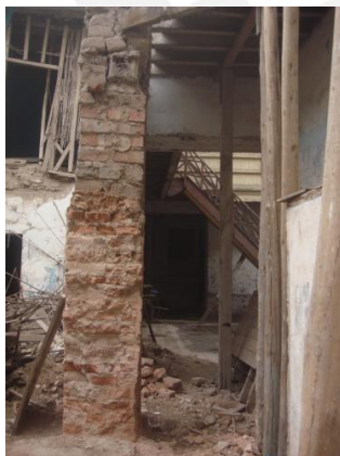
Foto 11: Columna del primer piso a punto del colapso.
