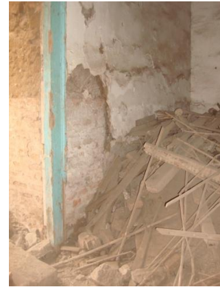
Foto 32: Desprendimiento de material y recubrimiento en malas condiciones.
