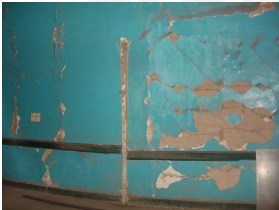
Foto 65: Desprendimiento de material y grietas.
