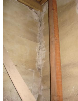
Foto 74: Grietas en unión de muros perpendiculares.
