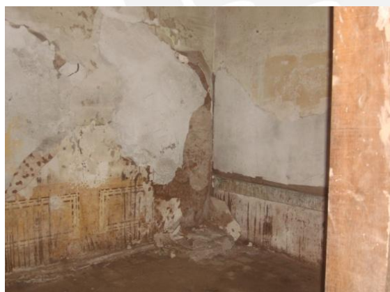
Foto 17: Desprendimiento de material.
