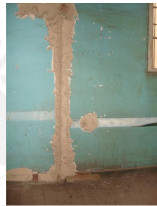
Foto 82: Muro de quincha picado.
