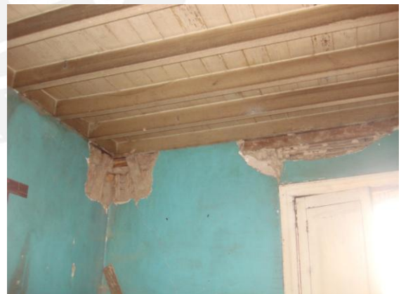
Foto 90: Desprendimiento de material en la esquina, exposición de madera.
