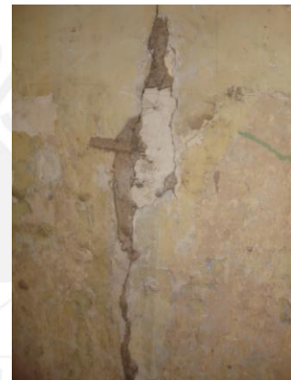
Foto 88: Grietas en muro de quincha.
