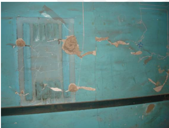
Foto 89: Grietas y desprendimiento de material en muro de quincha.
