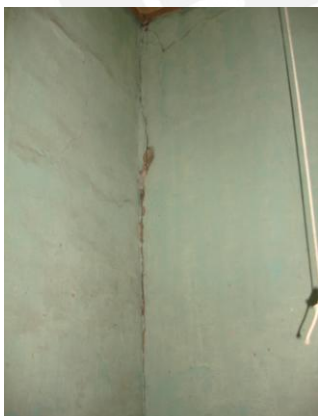
Foto 59: Grieta en unión de muros.
