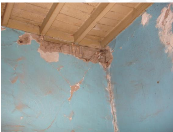
Foto 95: Grieta en unión de muros y desprendimiento de material.
