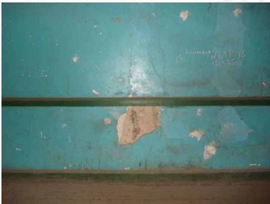
Foto 69: Desprendimiento de material.
