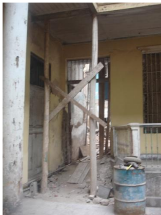
Foto 9: Colapso del pasillo, puntales sosteniendo losa superior.
