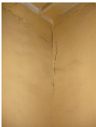
Foto 15: Grietas en la unión de muros.
