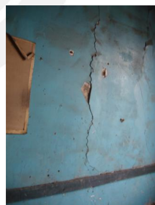
Foto 54: Grietas en muro de quincha.
