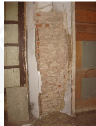
Foto 22: Desprendimiento de recubrimiento.
