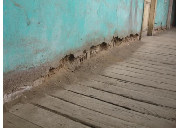
Foto 86: Desprendimiento de material y presencia de humedad.
