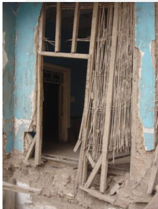
Foto 41: Colapso de muro de quincha.
