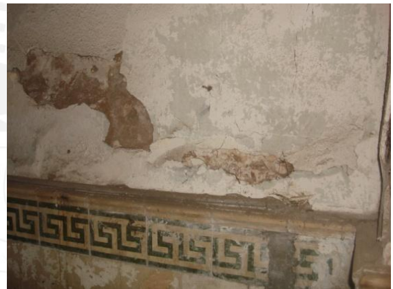
Foto 28: Pérdida de recubrimiento.
