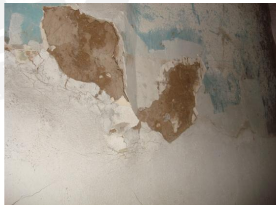
Foto 6: Desprendimiento de material en muro de Adobe.
