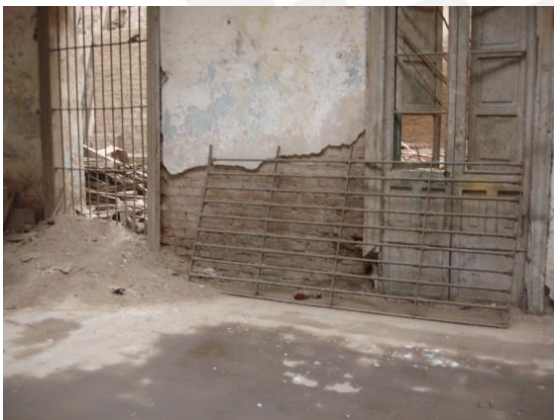
Foto 35: Desprendimiento del recubrimiento en muro de adobe.
