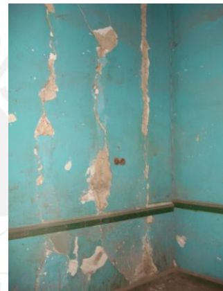
Foto 70: Grietas en muro de quincha.
