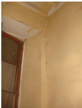
Foto 13: Grietas en la unión de dos muros.
