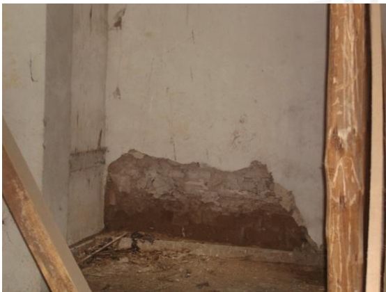
Foto 27: Desprendimiento del material de recubrimiento y presencia de humedad.
