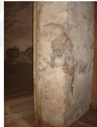
Foto 30: Desprendimiento de material de recubrimiento y agrietamiento de muro.
