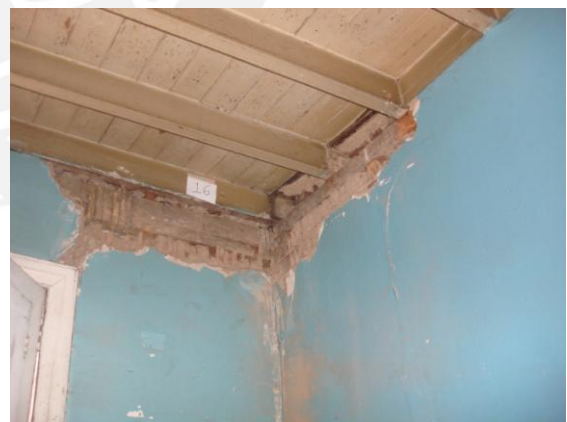
Foto 96: Desprendimiento de material en casi toda la parte superior del muro.
