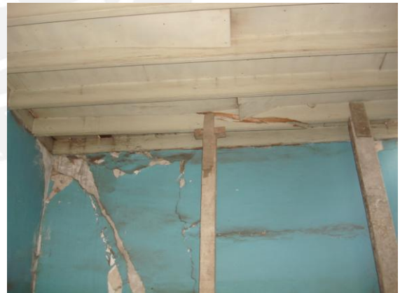
Foto 78: Agrietamiento de muros de quincha así como apuntalamiento de entrepiso
