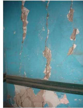
Foto 68: Grietas en muro de quincha.
