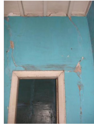
Foto 62: Grietas a lo largo del muro y en el dintel.
