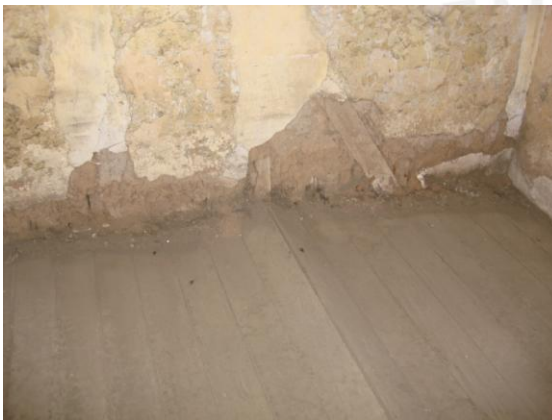
Foto 87: Desprendimiento de material en parte inferior del muro de quincha.
