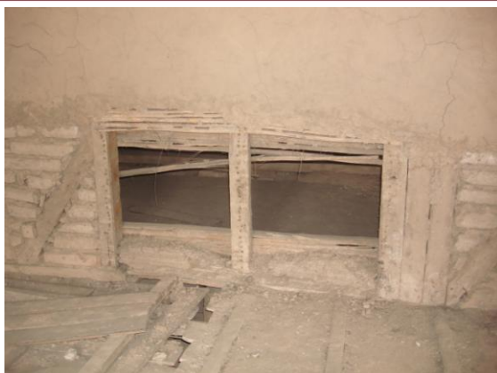
Foto 49: Desprendimiento de todo el material del muro de quincha (Adobes y tornapuntas).
