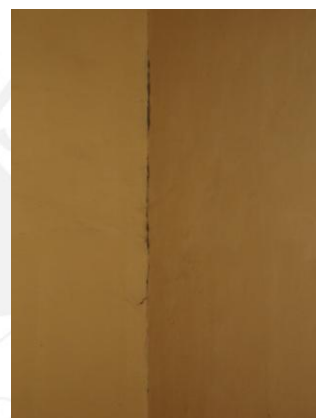
Foto 58: Grieta en unión de muros.
