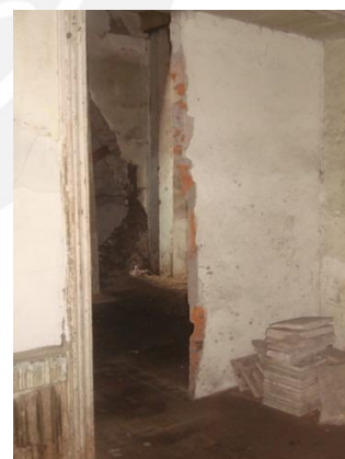
Foto 18: Colapso de una parte del muro.
