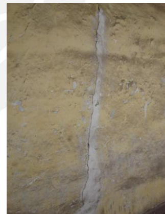
Foto 84: Agrietamiento en muro de quincha.
