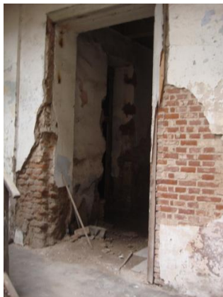
Foto 33: Desprendimiento de recubrimiento
