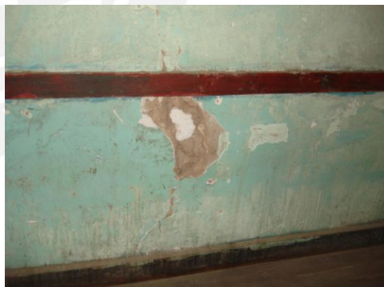
Foto 60: Desprendimiento de material.
