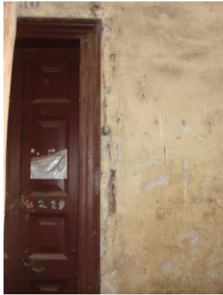
Foto 37: Agrietamiento en muro de quincha.
