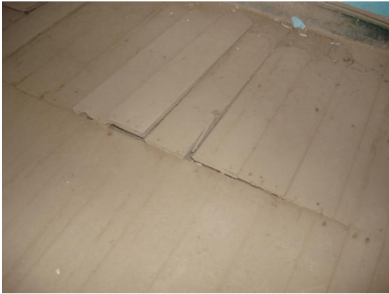
Foto 67: Pérdida de continuidad en entablado superior.
