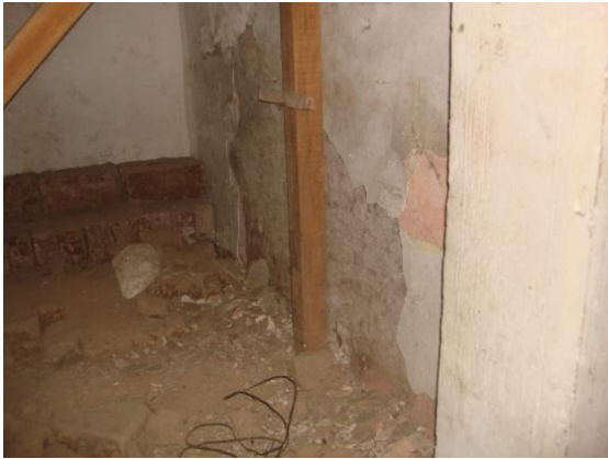
Foto 25: Desprendimiento del material de recubrimiento
