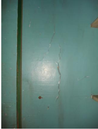
Foto 85: Grieta en muro de quincha.
