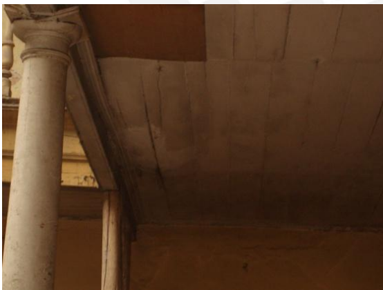
Foto 5: Losa del pasillo del piso superior presenta deflexiones.
