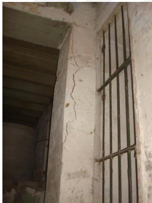
Foto 29: Grietas a lo largo de la columna.
