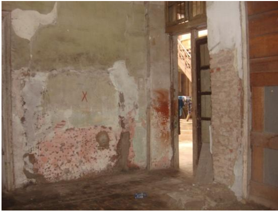
Foto 19: Desprendimiento de recubrimiento y de material de albañilería.
