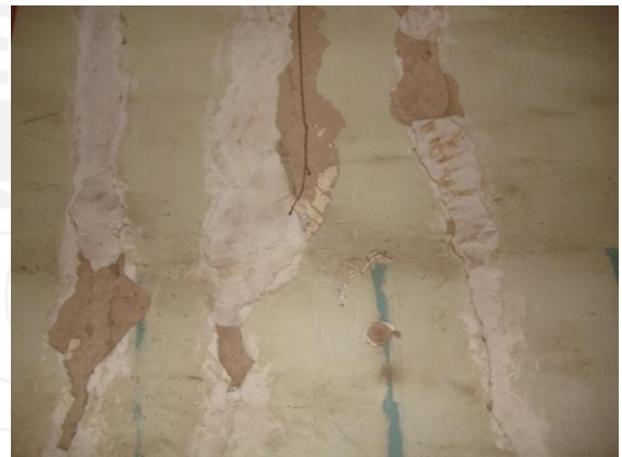
Foto 76: Grietas a lo largo de muro de quincha.
