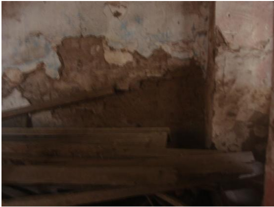
Foto 31: Desprendimiento de recubrimiento.
