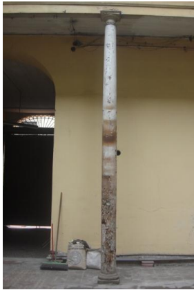
Foto 1: Columna de madera. La madera se encuentra en muy mal estado.
