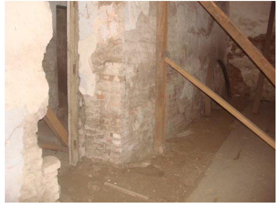
Foto 26: Desprendimiento del material de recubrimiento
