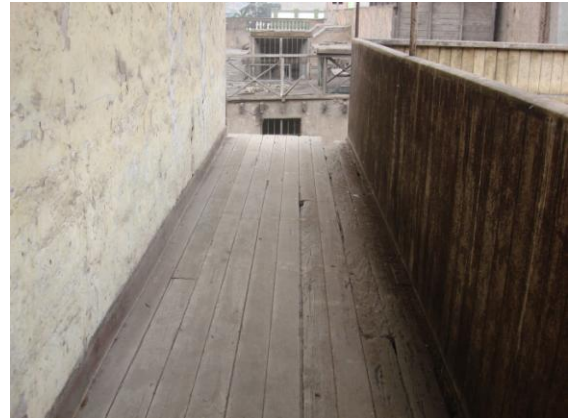
Foto 80: Colapso de Estructura.
