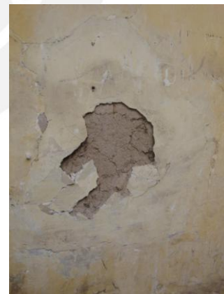
Foto 36: Desprendimiento de material y presencia de humedad.
