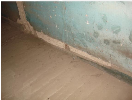
Foto 83: Desprendimiento de material en la parte inferior del muro.
