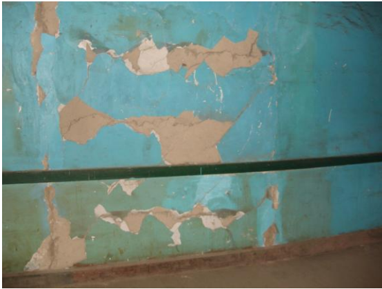
Foto 61: Desprendimiento de material y grietas en muro de quincha.
