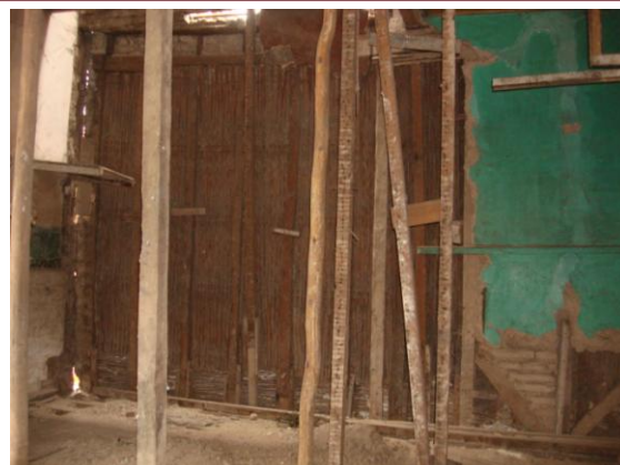
Foto 50: Colapso de muro de quincha.
