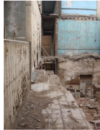
Foto 38: Colapso de estructura.
