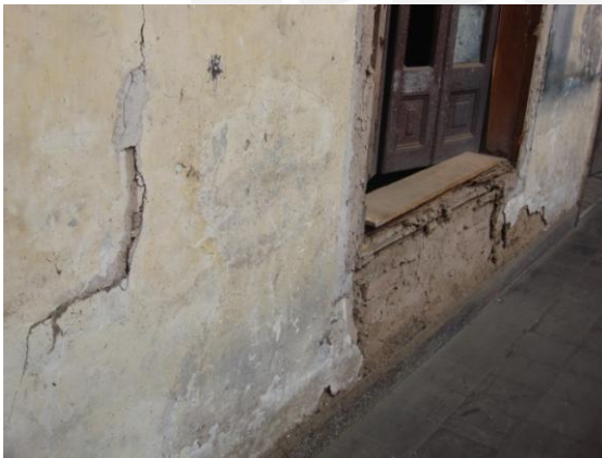
Foto 71: Grietas en muro de quincha, desprendimiento de material.
