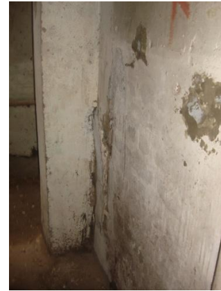
Foto 20: Grieta entre muro y columna.
