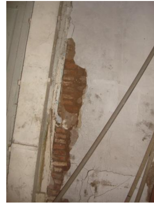
Foto 8: Desprendimiento de material. Exposición al ambiente y presencia de humedad.
