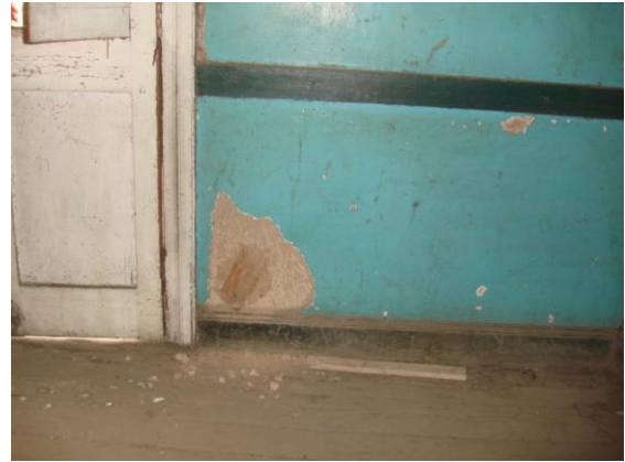
Foto 92: Desprendimiento de material, se puede observar el tornapunta del muro de quincha.
