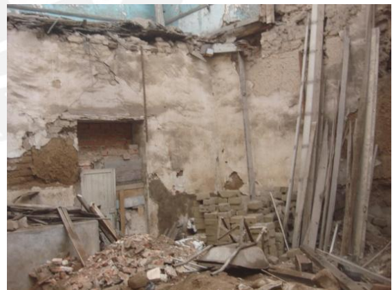
Foto 12: Colapso de la estructura. Existe separación entre el sistema de entrepiso y el muro
