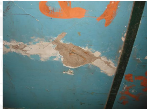
Foto 94: Grieta en muro de quincha.
