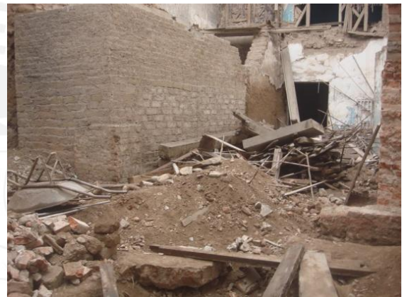
Foto 10: Colapso total la estructura.
