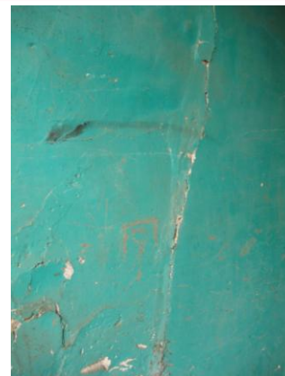
Foto 44: Grietas en muro de quincha.
