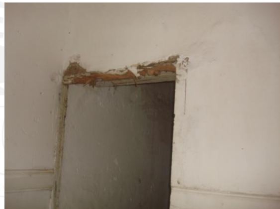
Foto 4: Marco de madera en mal estado, deflexión del elemento horizontal.
