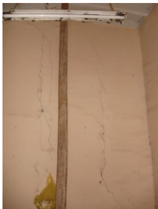
Foto 43: Grietas superficiales a lo largo del muro
