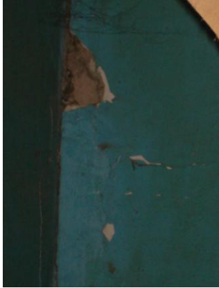
Foto 73: Agrietamiento y desprendimiento de material en muro de quincha.
