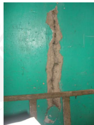
Foto 46: Grietas en muro de quincha.
