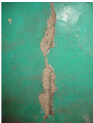
Foto 45: Grietas en muro de quincha
