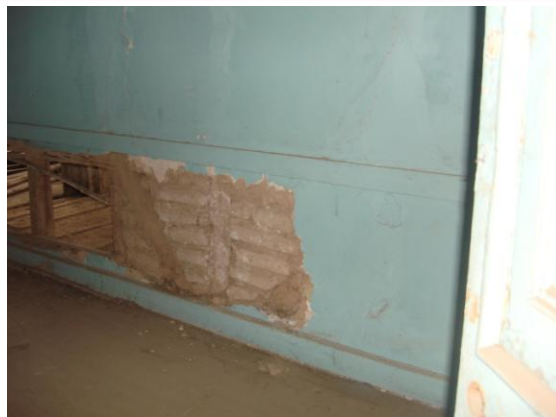
Foto 56: Desprendimiento de material en muro de quincha.
