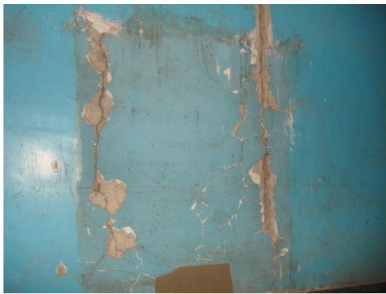
Foto 39: Grietas profundas en muro de quincha.
