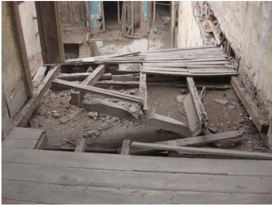
Foto 79: Colapso de estructura.
