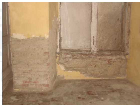
Foto 16: Desprendimiento de recubrimiento y de material de albañilería.
