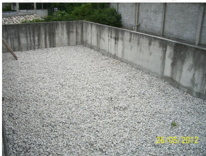
Foto 20. Lecho de secado de PTAR Portal El Sol, Guayaquil – Ecuador.
