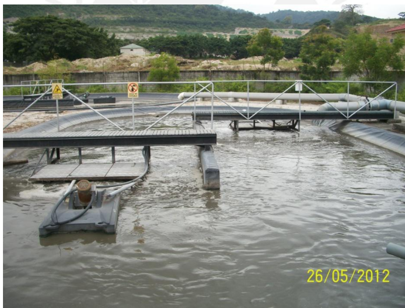
Foto 16. Planta de tratamiento SOTAS, urbanización Portal El Sol, Guayaquil – Ecuador.
