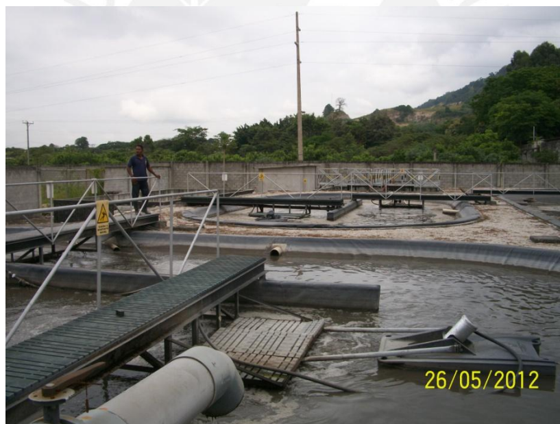
Foto 18. Lagunas de aireación y digester de lodos, Urb. Portal El Sol, Guayaquil – Ecuador.
