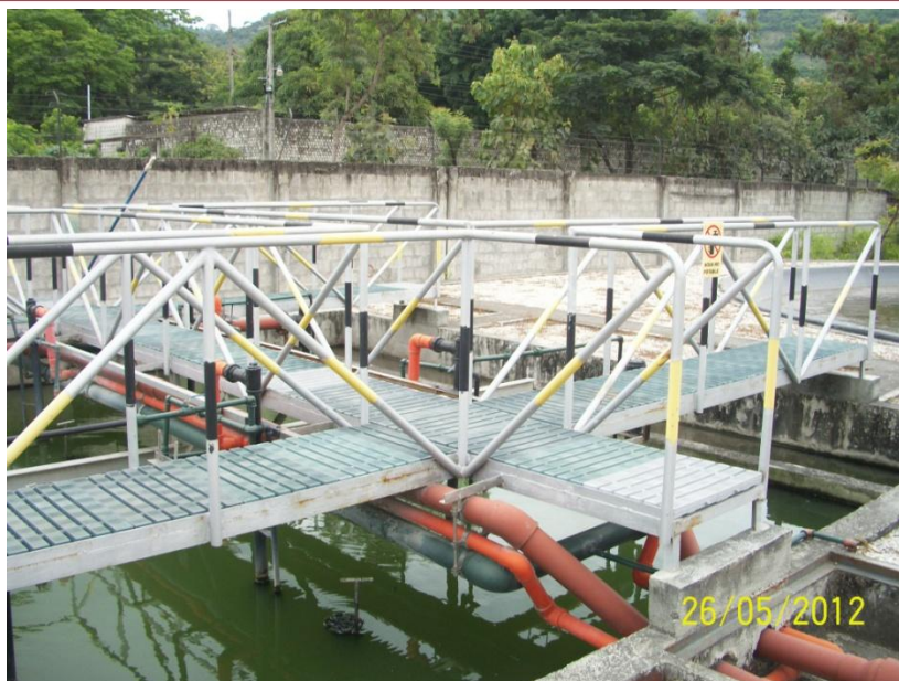
Foto 21. Clarificador PTAR Portal El Sol, Guayaquil – Ecuador.
