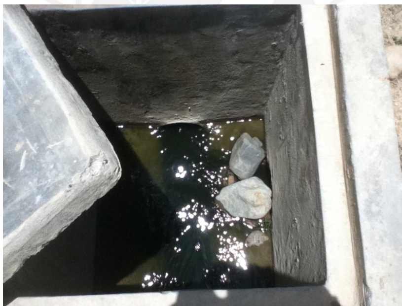
Foto 12. Agua mal tratada de PTAR sin mantenimiento en Sapallanga – Huancayo.
