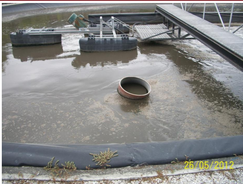
Foto 23. Aireadores y Baffle en laguna de aireación PTAR Portal El Sol.
