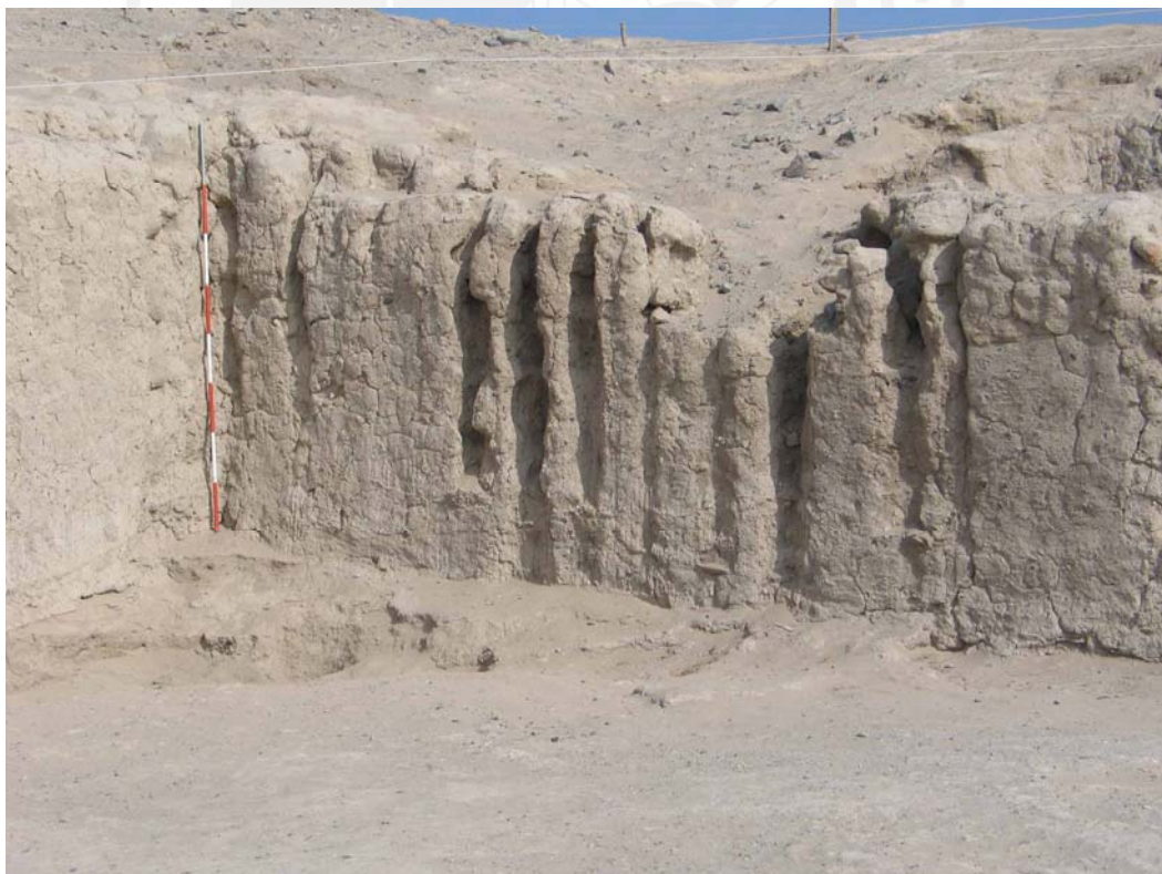
Fig.57d: Detalle de un fragmento del Muro Sur de la Plaza donde se evidencia la grave erosión a que sufrió el muro, tanto en su cabecera como en su cara. Vista Noreste.
