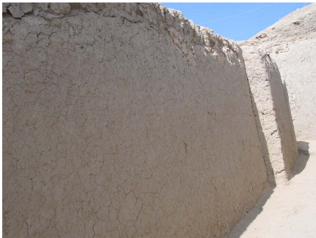
Fig.37c: Muro de Tercera Fase cuyo enlucido se encontró bien conservado. Foto: María Gasior.
