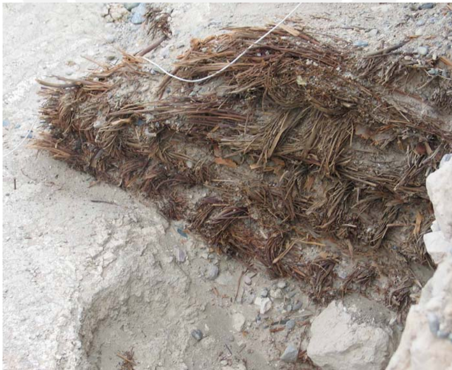
Fig.21b: Atados de chala dispuestos en capas, alternados con tierra y material vegetal diverso como parte del relleno constructivo.
