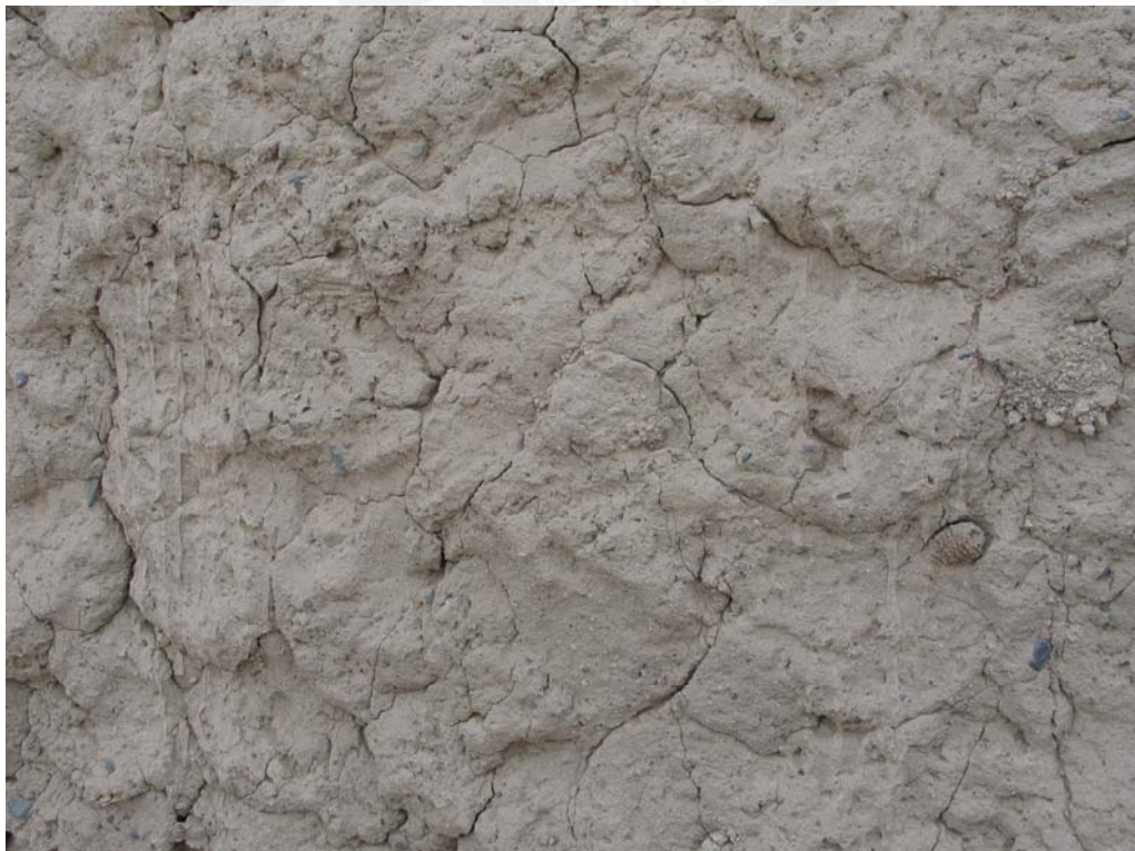
Fig.37b: Muro de Tercera Fase con enlucido colocado de manera irregular y con huellas de erosión por caída de agua. Foto: María Gasior.
