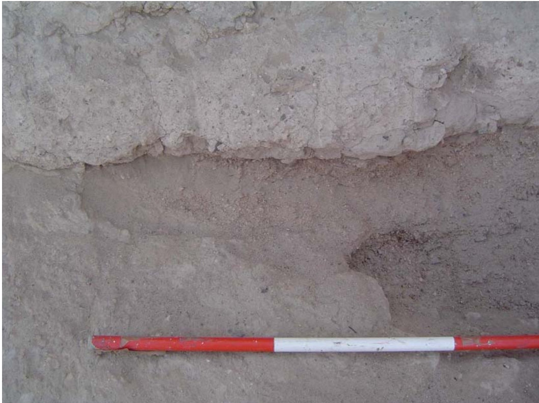
Fig.52c: Detalle del muro Este de la Plaza, donde se observa que sus cimientos se encuentran descansando sobre la capa arcillosa estéril.
