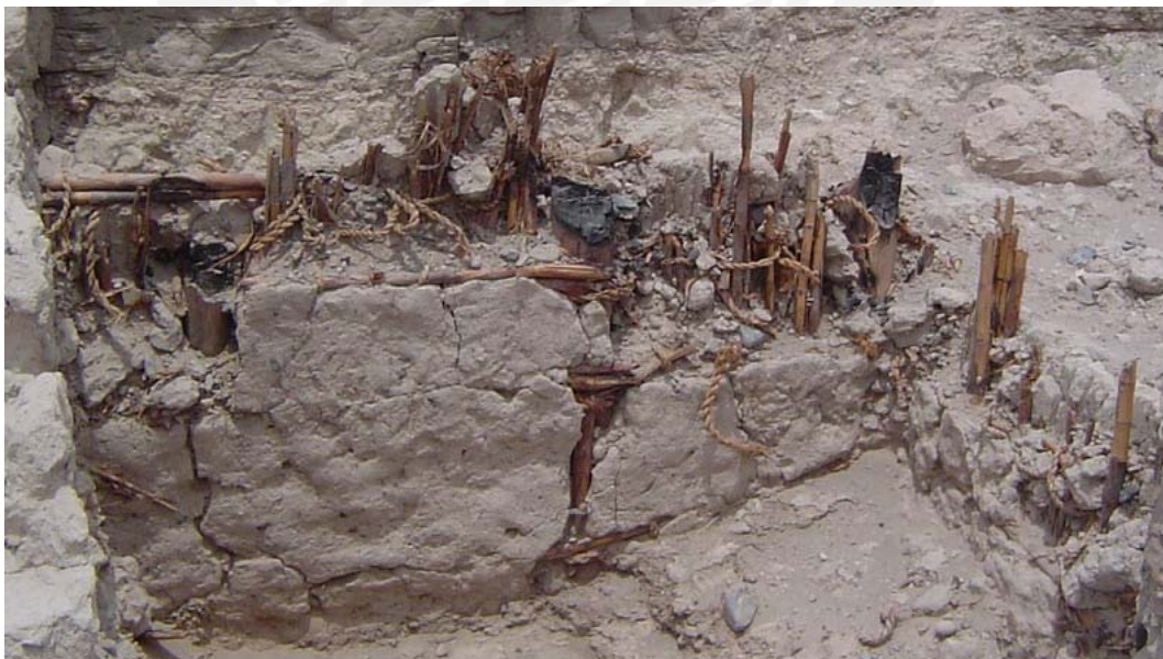
Fig.28c: Detalle del muro de quincha. Nótese las huellas de quema de las cañas y postes de algarrobo que conforman la estructura de la quincha, así como los restos de cuerdas de fibra vegetal.
