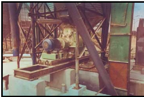
Molino de martillos instalado Ate Vista posterior
