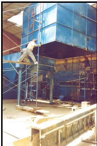
División de tolva en dos partes, se arman dos torres de andamios lateralmente.
