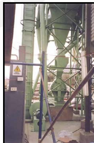
Molino nuevo instalado Ate Segunda molienda
