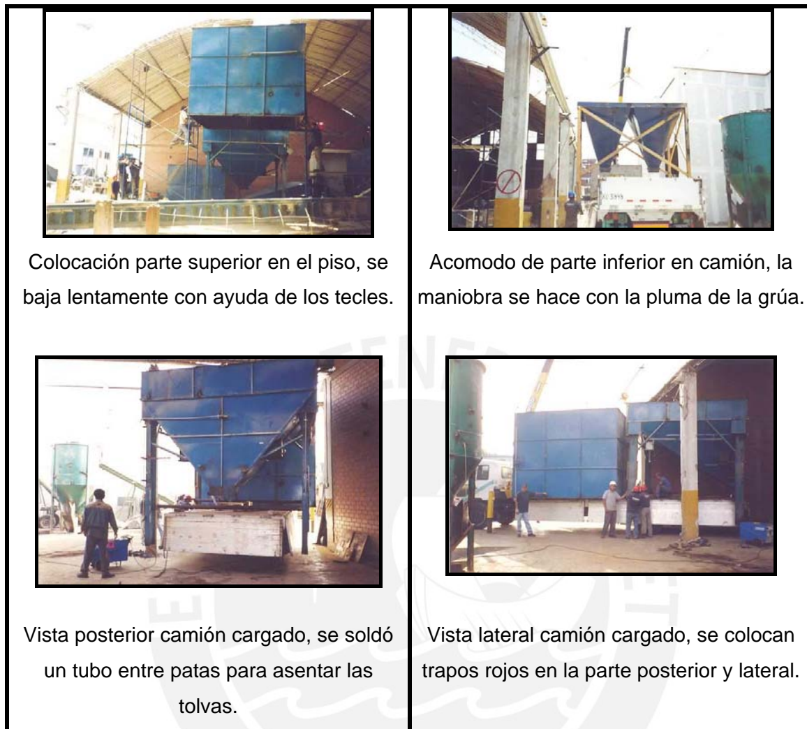
Figura 3.11.- Secuencia para el desmontaje y carga de las tolvas de maíz molido.
