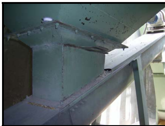
Figura 4.5.- Compuerta tipo guillotina a la descarga de la tolva pulmón.
