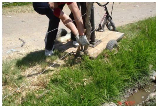
FIJACIÓN DE ALAMBRES AL POSTE DE MADERA
