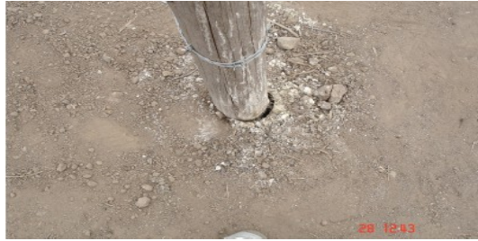
POSTE SIN FRAGUA DE CEMENTO, CON TEMPLADOR.
