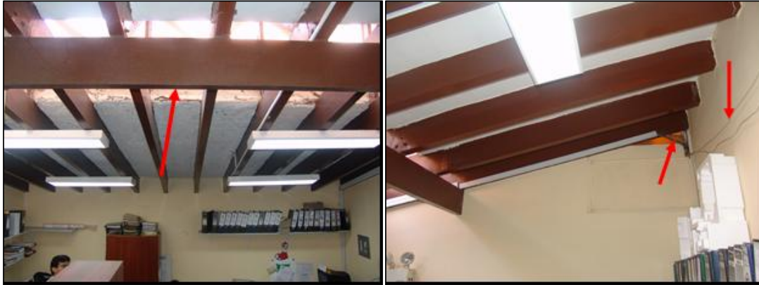
FOTO: Techo de la DNPE deteriorado y con documentos apunto de alcanzar el techo, un sismo y cae a la cabeza de la persona que esta trabajando debajo
