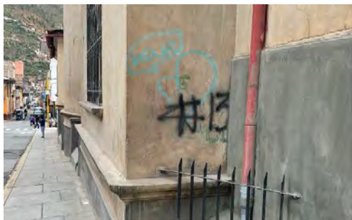
Figura 31. Vandalismo en una de las paredes de la catedral Santa Ana. Espinoza (2021)
