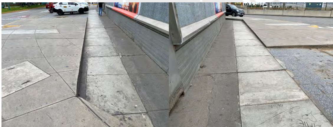
Figura 6.18: Ausencia de rampas en el punto 2
