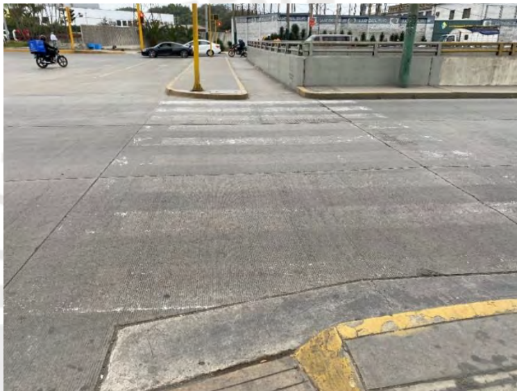
Figura 6.1: Señalización horizontal poco visible
