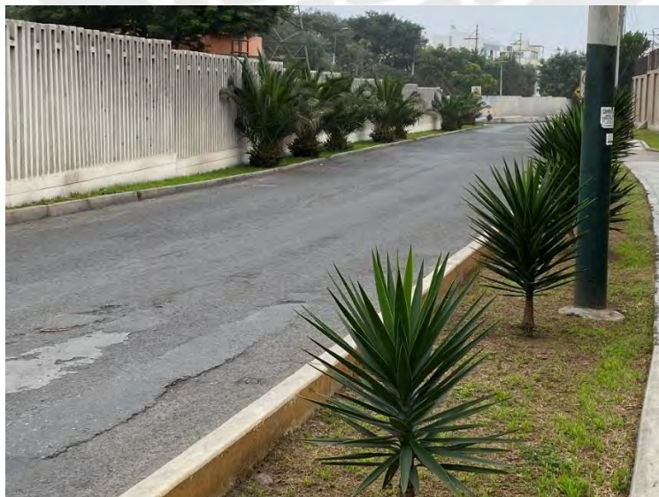
Figura 6.2: Falta de separación de carriles
