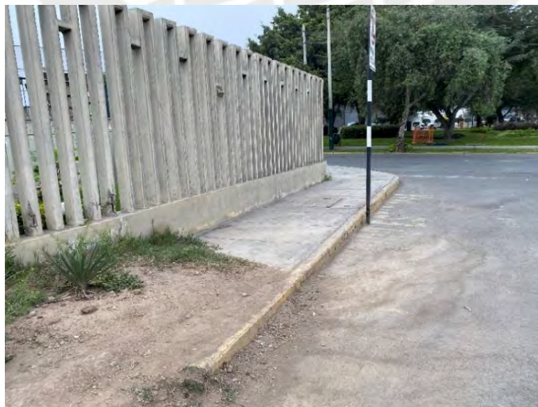
Figura 6.20: Discontinuidad de vereda en el punto 1
