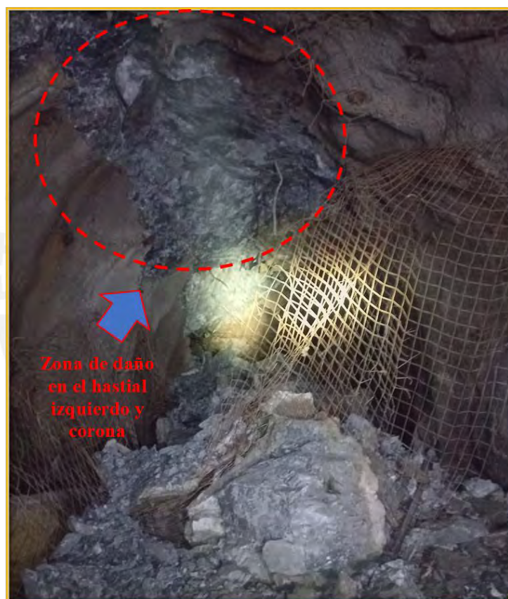
Ilustración 39: Ubicación más frecuente de los daños en el soporte de roca con referencia al laboreo minero del sector Sur
