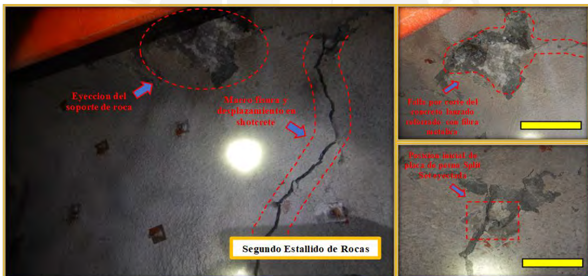
Ilustración 30 : Estallido de rocas en Rampa 8550 (+) , daños en el concreto lanzado.
