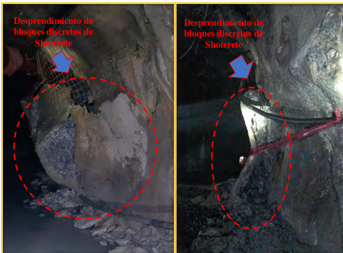
Ilustración 40 : Comportamiento típico post falla del concreto reforzado con fibras ante estallidos de roca para diferentes sectores de evaluación.
