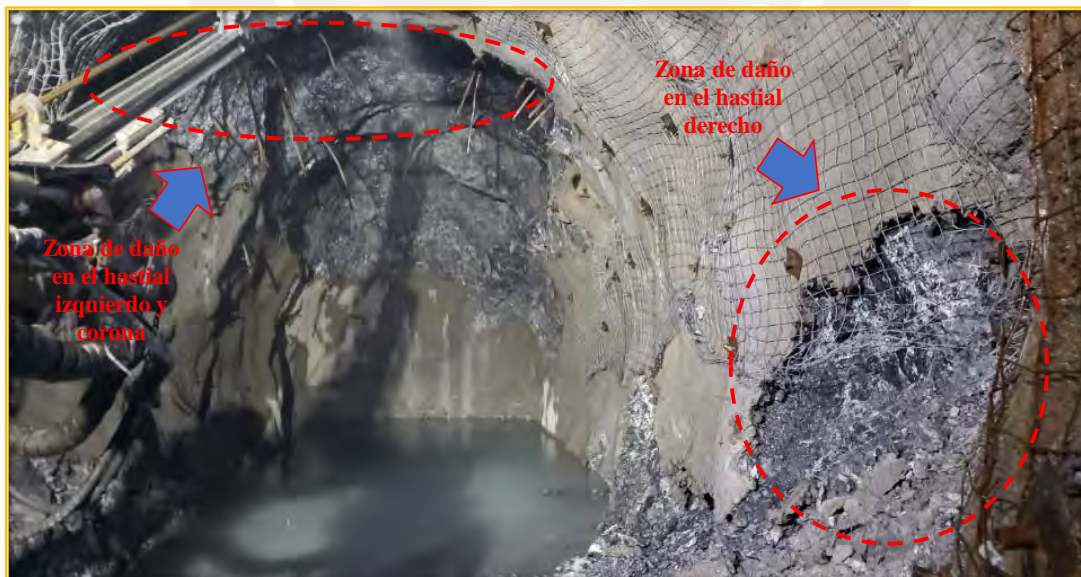
Ilustración 38 : Ubicación más frecuente de los daños en el soporte de roca con referencia al laboreo minero del sector Oeste , Este y Norte.
