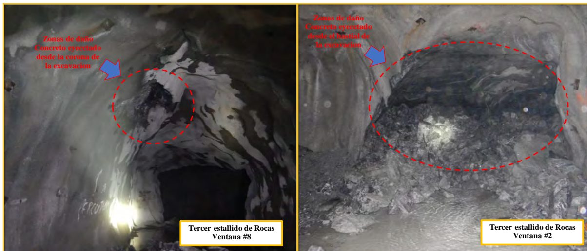
Ilustración 35 : Daños en el soporte de roca asociados al tercer estallido en roca en el Tajeo 8610 en múltiples ventanas afectadas.
