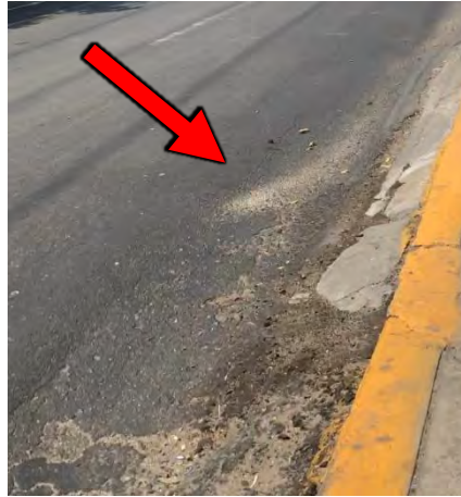
Figura 4.1: Defectos en los laterales del tramo inspeccionado (Fuente: Propia)
