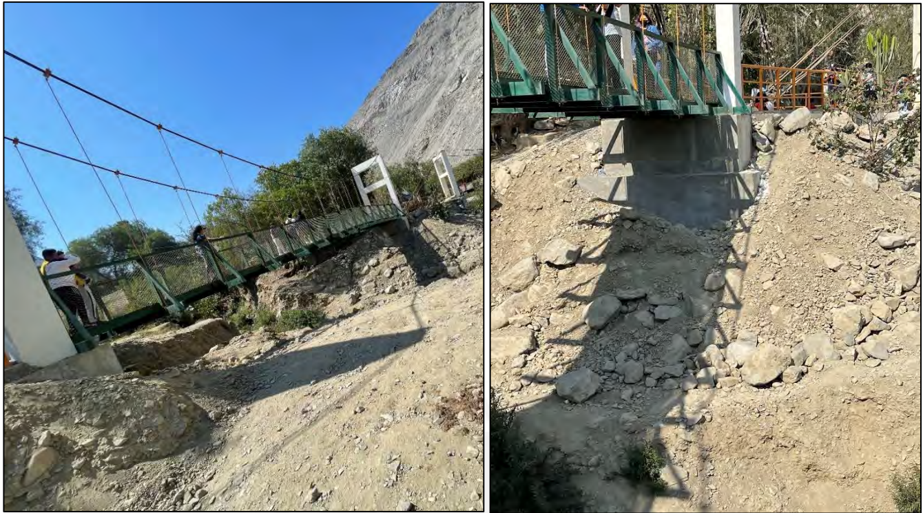
Figuras 12 y 13. Fotografías del puente peatonal y zona propensa a erosión en la quebrada Higuerón, 2022. Fotografía de la autora.
