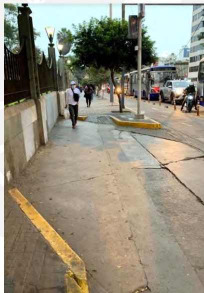
Figura 17. Desniveles en la acera. Fuente: Propia
