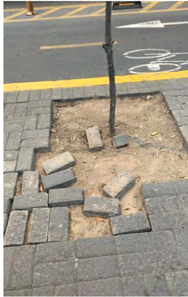
Figura 18. Adoquines fuera del lugar. Fuente: Propia
