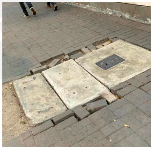
Figura 19. Buzones con mal acabado. Fuente: Propia
