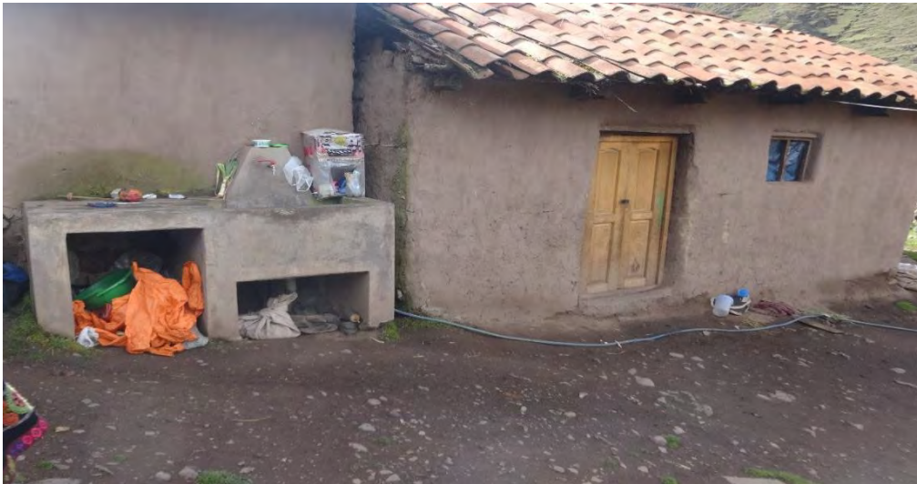
Ilustración 10 Lavatorio domiciliario instalado por PRONASAR
