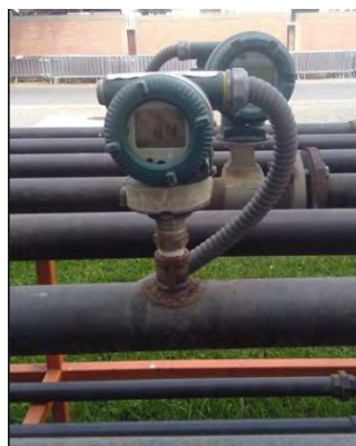
Figura 2.4. Sensor transmisor de presión instalado en la planta piloto de transportes de fluidos. Fuente: Elaboración propia
