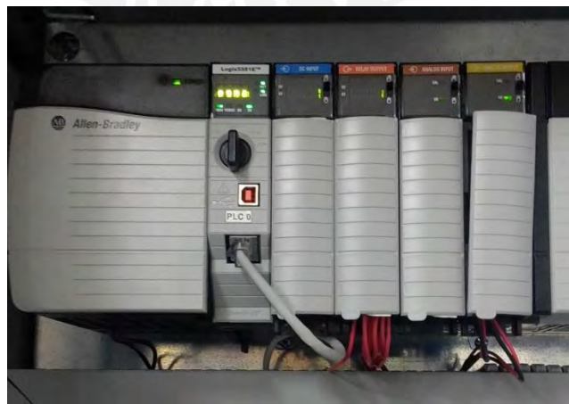
Figura 2.8. PLC ControlLogix y tarjetas de entradas y salidas instaladas en el tablero de mando de la planta piloto de la PUCP. Fuente: Elaboración propia
