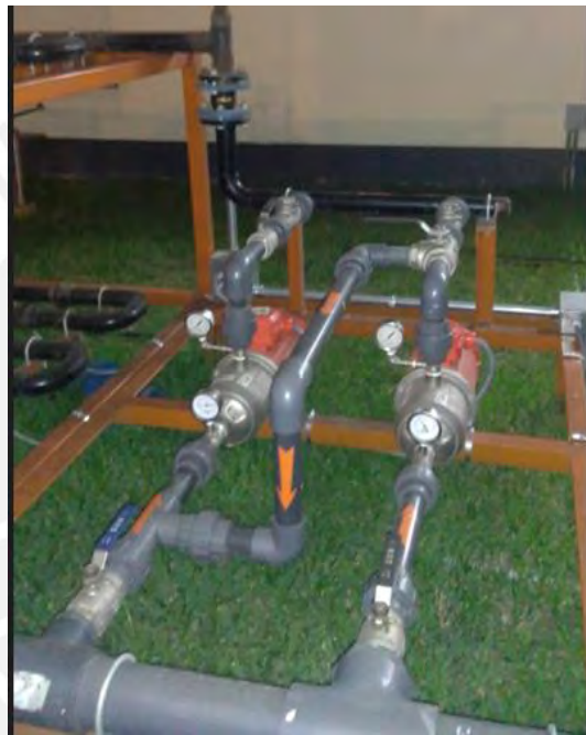
Figura 2. 5 Electrobombas centrífugas instaladas en la planta piloto de transportes de fluidos de la PUCP. Fuente: Elaboración propia
