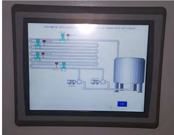
Figura 2.7. Panel HMI-Panel View Plus instalado en el tablero de mando de la planta piloto de la PUCP. Fuente: Elaboración propia
