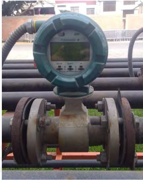
Figura 2. 3 Sensor Transmisor de Flujo instalado en Planta piloto de transportes de fluidos Fuente: Elaboración propia
