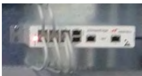
Figura 2.10. Switch de red de 8 puertos, instalado en el tablero de mando de la planta piloto de la PUCP. Fuente: Elaboración propia
