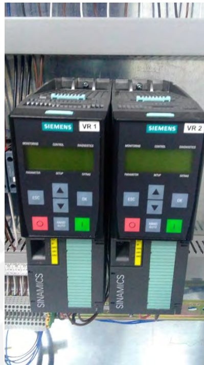
Figura 2. 6. Variadores de Velocidad instalados en el tablero de mando Fuente: Elaboración propia
