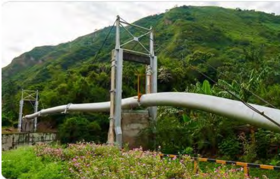
Figura 1.1. Oleoducto Norperuano para el transporte del petróleo crudo desde la amazonia a la costa. Fuente: Foto Petroperú.
