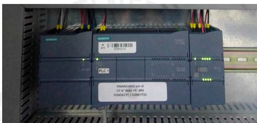
Figura 2.9. PLC S7-1200, tarjeta de entrada analógica y fuente de alimentación instalados en el tablero de mando de la planta piloto de la PUCP. Fuente: Elaboración propia
