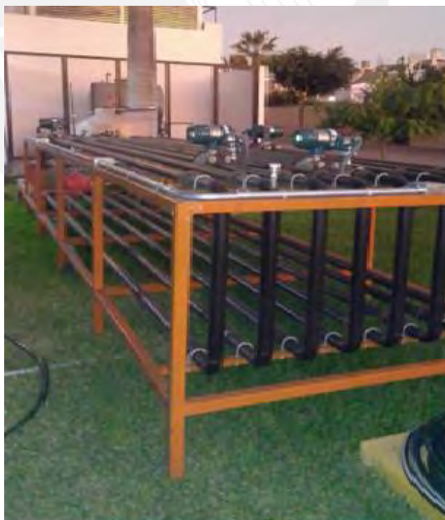
Figura 2.1. Vista general de la planta piloto de transportes de fluidos de la PUCP. Fuente: Elaboración propia
