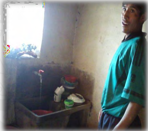
Foto 28: Lavatorio en cocina mejorada
