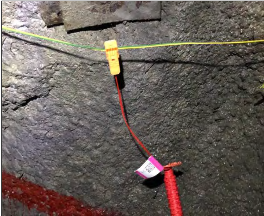
Figura 36. Conexión de detonadores electrónicos a la línea M35.
