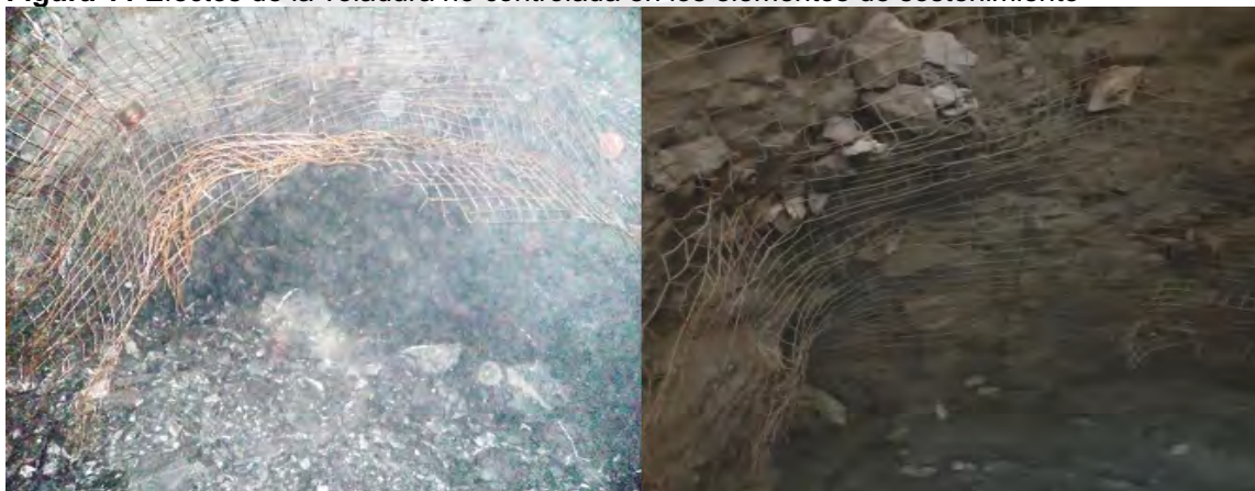
Figura 11 Efectos de la voladura no controlada en los elementos de sostenimiento
