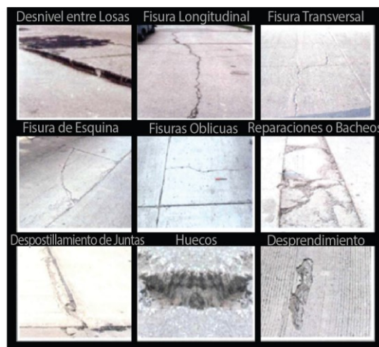
Figura 7: Daños en pavimentos rígidos. Fuente: MTC (2014)
