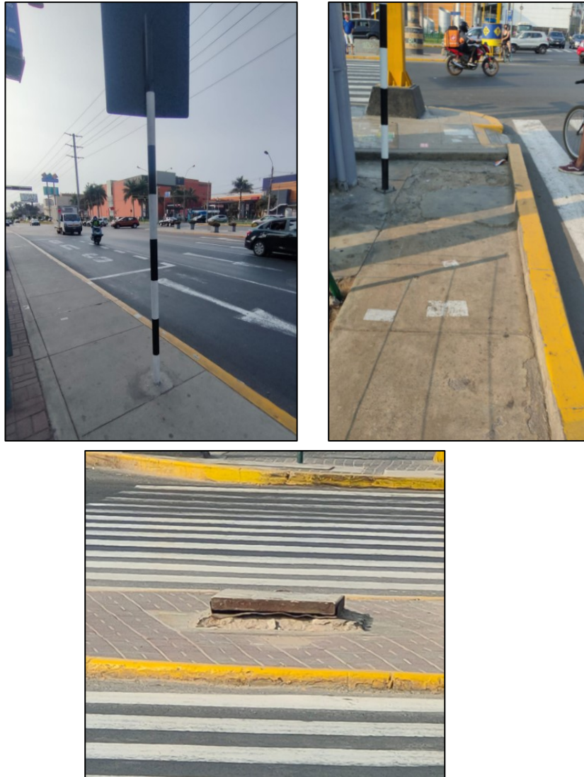
Figura 45: Desniveles y obstrucciones que impiden el libre desplazamiento de las personas con movilidad reducida. Fuente: Propia
