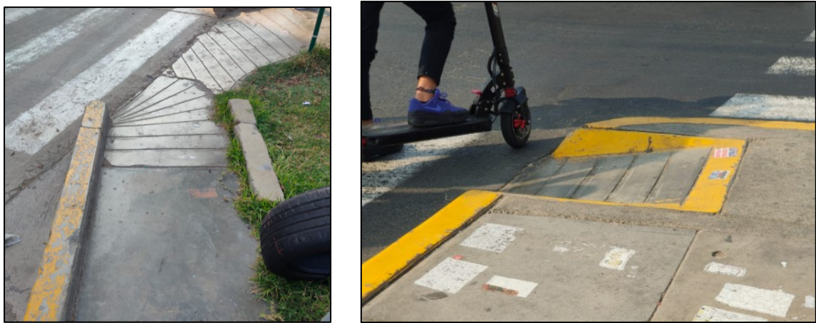
Figura 44: Ancho inadecuado de rampas. Fuente: Propia
