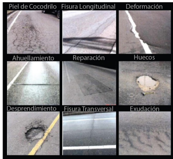
Figura 6: Daños en pavimentos flexibles. Fuente: MTC (2014)
