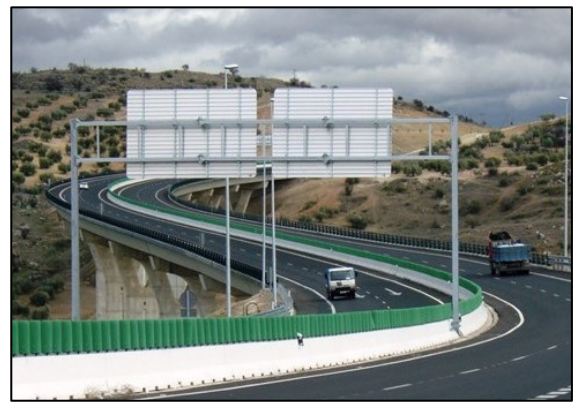
Figura 17: Pantallas anti-deslumbramiento. Fuente: Proinbal.
